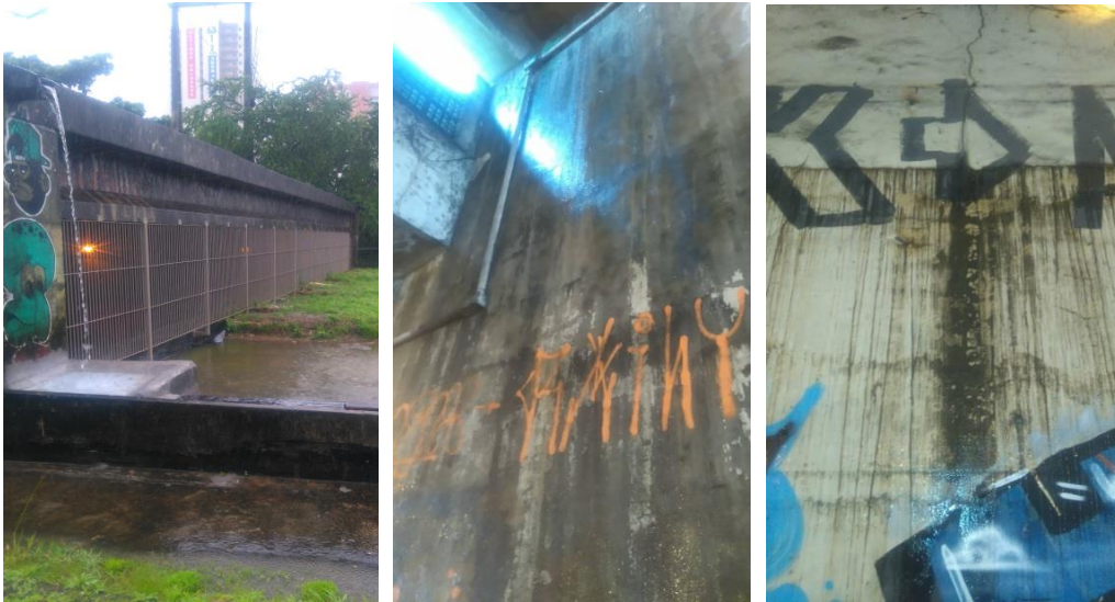
Figuras 11, 12 e 13 - Laje superior e canteiro alagados, infiltrações advindas da laje superior e fissura vertical com fluxo de água
