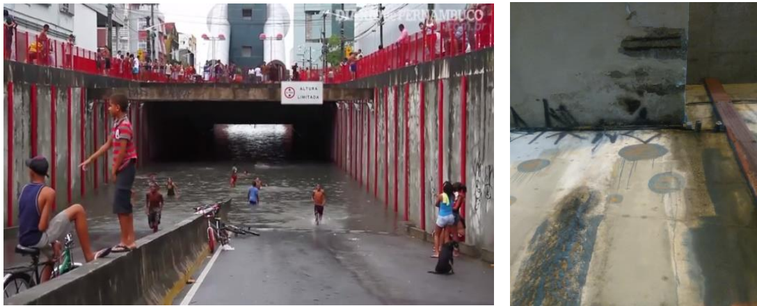
Figuras 4 e 5 – Túnel do Pina durante alagamento e manchas de umidade na face da parede diafragma
