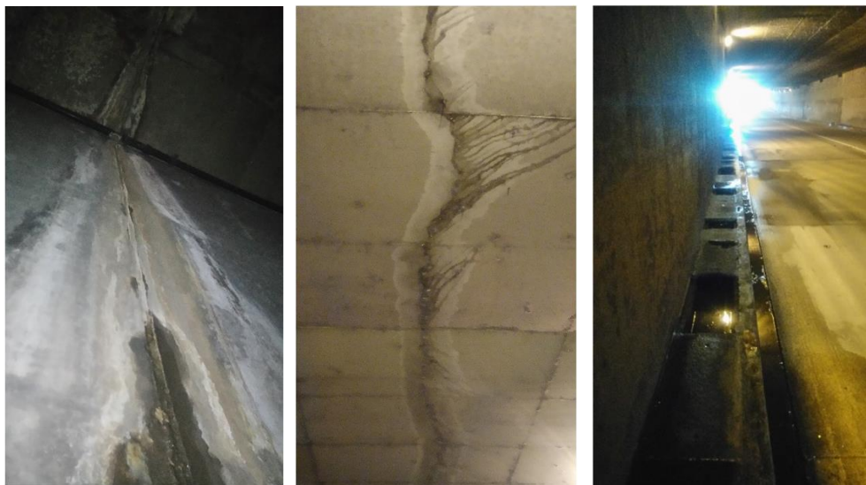
Figuras 19, 20 e 21 - Eflorescência causada por percolação de água nas juntas, manchas de infiltração em fissuras e canaletas com placas quebradas e entupidas
