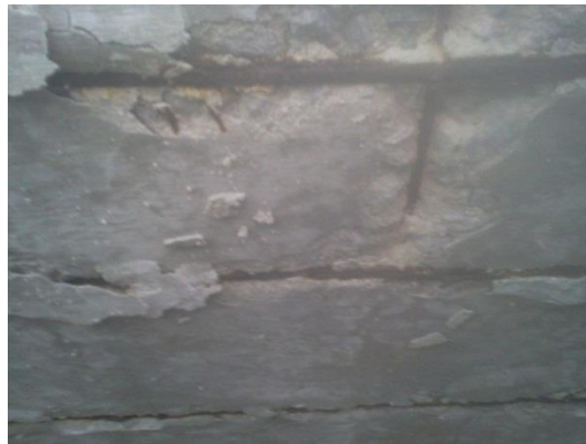
Figura 7 – Placa de concreto deteriorada
