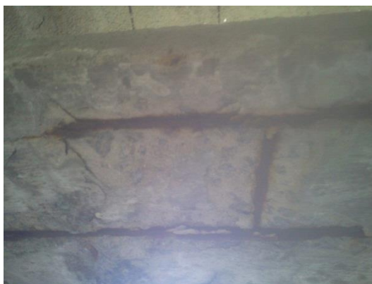
Figura 6 – Placa de concreto deteriorada
