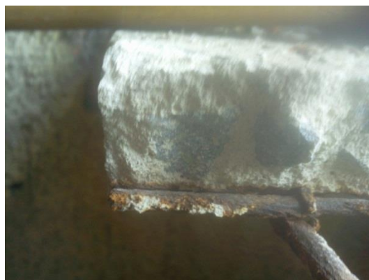
Figura 8 – Resultado do ensaio de profundidade de carbonatação. Concreto totalmente carbonatado
