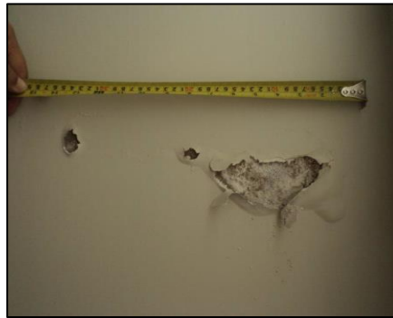
Figura 4 –Bolha na Pintura
