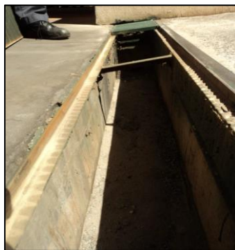
Figura 13 – Ralo, causa da infiltração
