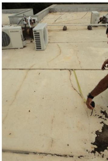
Figura 14 – Fissuras na Cobertura
