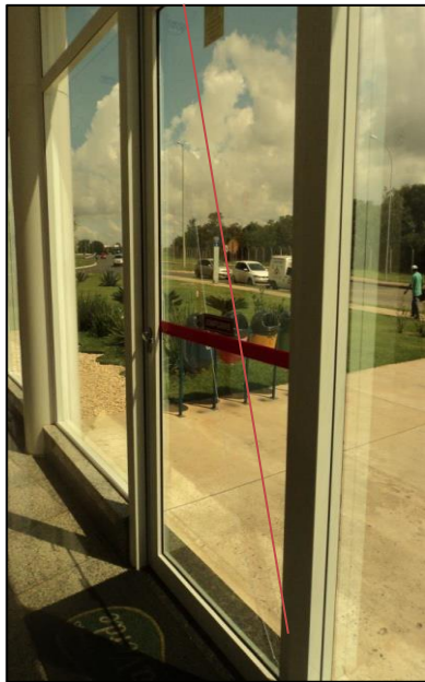
Figura 2 – Trinca porta de Acesso
