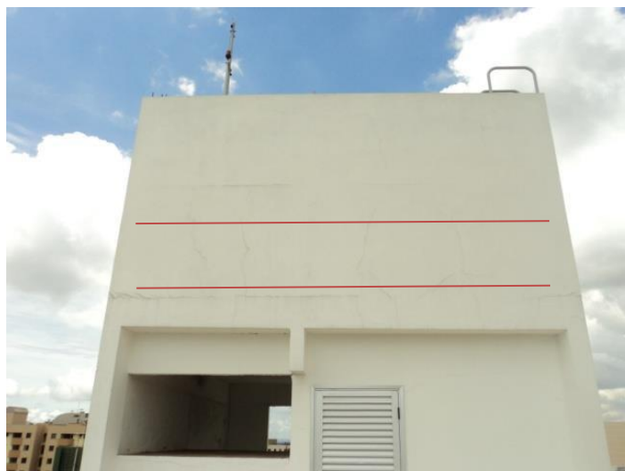
Figura 15 - Fissuras na Caixa D'água
