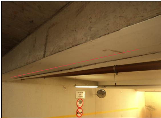
Figura 11 – Recalque Junta Estrutural
