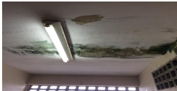
Figura 13 – Presença de mofo e bolor na EREM 2
