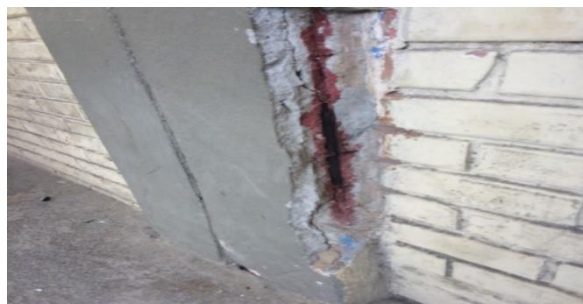
Figura 6 – Armadura exposta EREM 9
