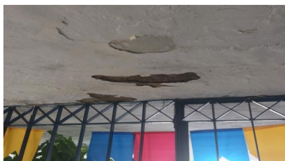
Figura 10 – Destacamento do reboco na EREM 10
