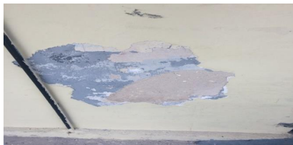
Figura 7 – Destacamento da Pintura na EREM 4
