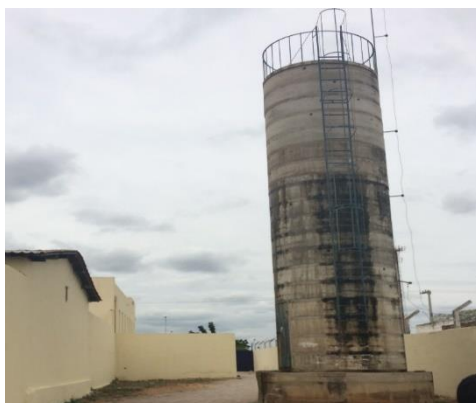
Figura 15 – Presença de mofo e bolor na EREM 17
