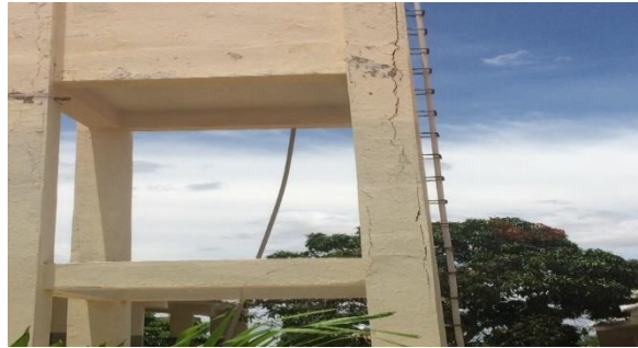
Figura 5 – Fissuras no reservatório de água da EREM 14
