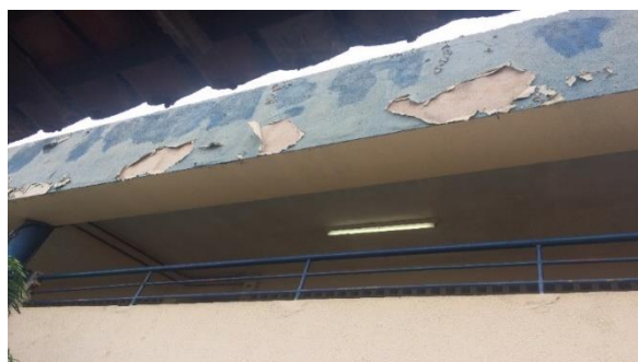
Figura 8 – Destacamento do reboco na EREM Brasilino José de Carvalho
