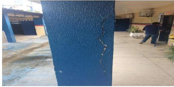
Figura 4 – Fissura em um pilar da EREM 6
