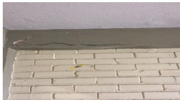
Figura 3 – Fissura com destacamento do reboco na EREM 9
