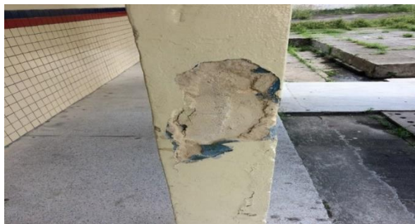
Figura 9 – Destacamento do reboco na EREM 7
