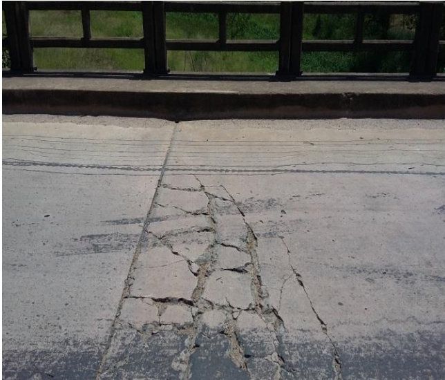
Figura 1 - Pavimento antes da recuperação
