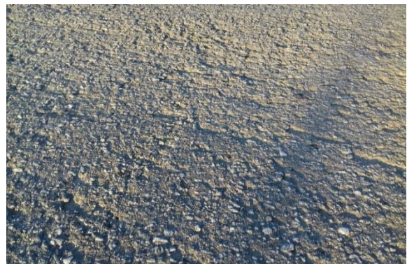
Figura 6 – Início do desgaste no pavimento da ponte 3
