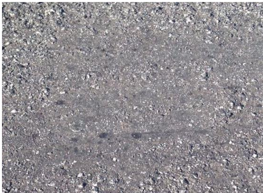
Figura 5 – Início de exsudação no pavimento da ponte 1
