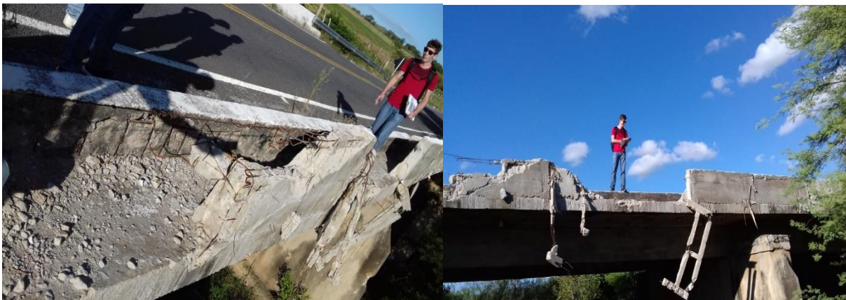
Figura 1 - Evidências de má restauração no guarda-corpo da Ponte 3 (P3)
