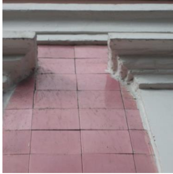
Manchas superficiais – Sujidades sem infiltrações.
