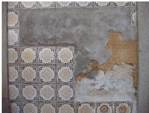
Figura 2 - Uso inadequado de argamassa de cimento em fachada de azulejos em Ovar, Portugal
