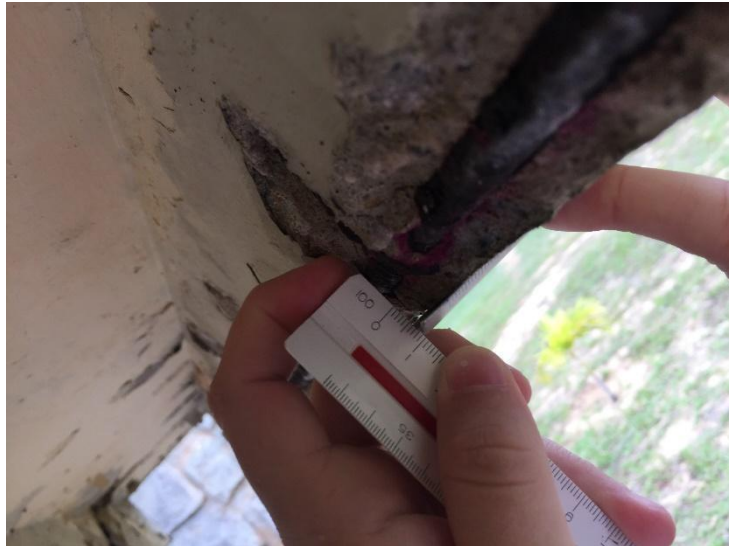
Figura 9 - Espessura do concreto carbonatado
