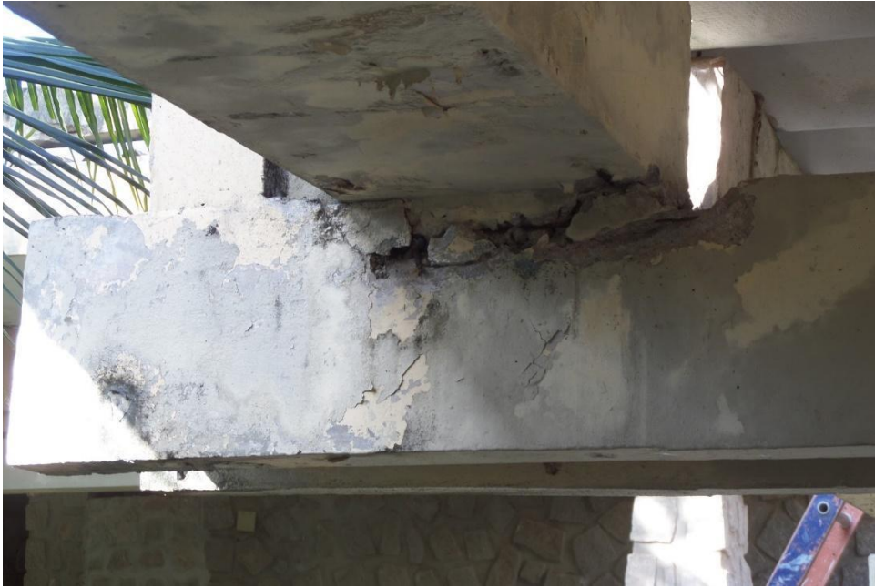
Figura 4 - Início do deslocamento do concreto
