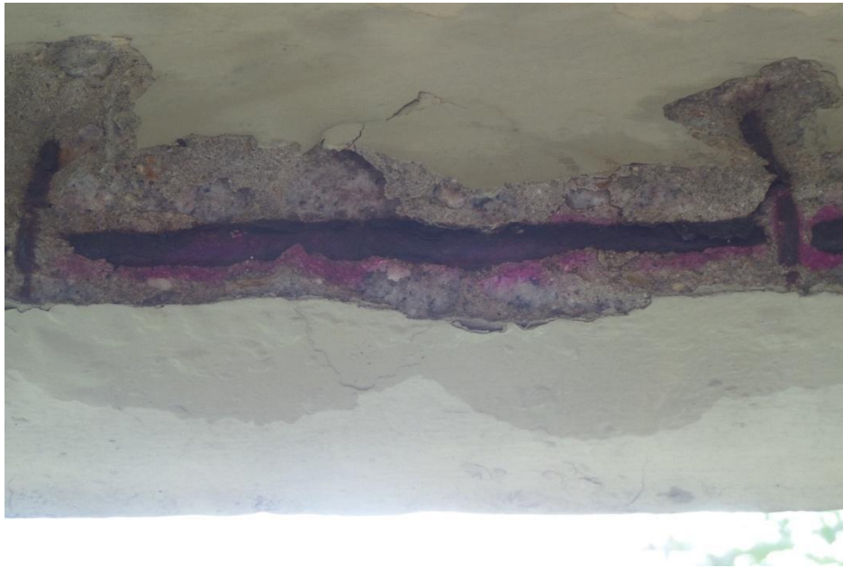
Figura 8 - Ensaio de carbonatação em um trecho da viga
