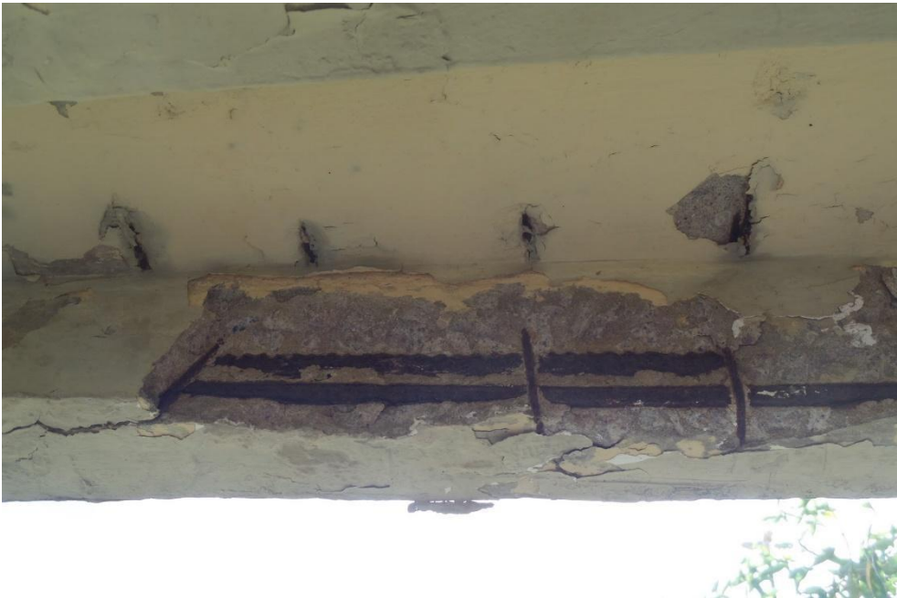
Figura 5 - Desprendimento da camada de concreto
