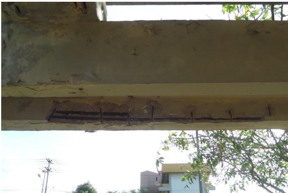
Figura 7 - Viga em situação precária
