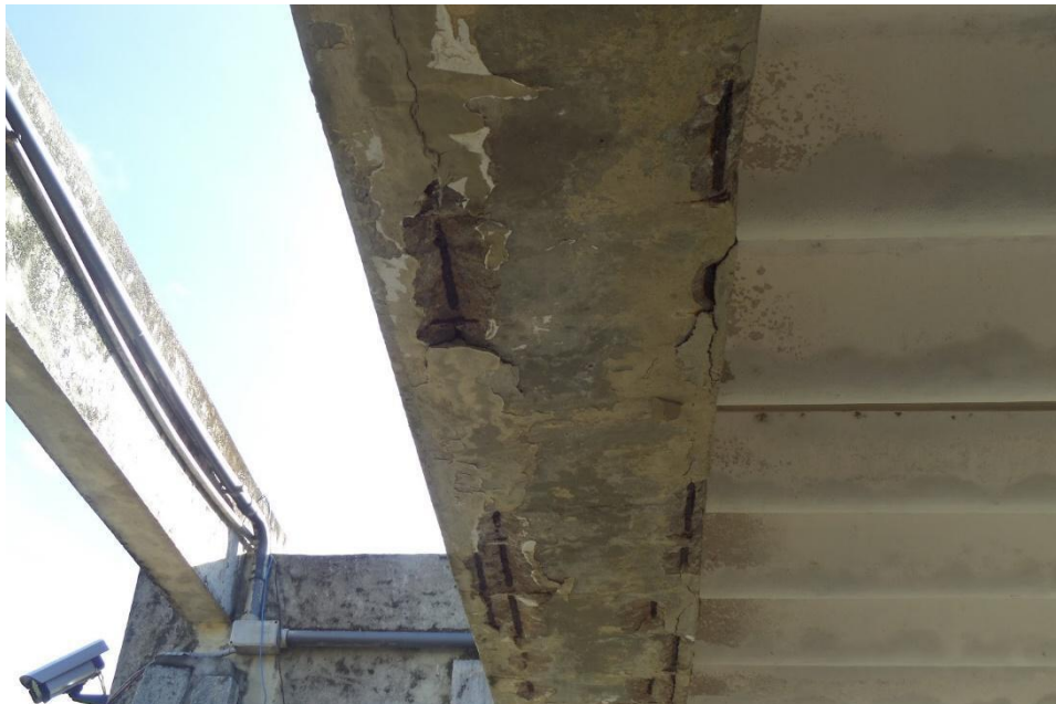
Figura 3 - Corrosão das armaduras
