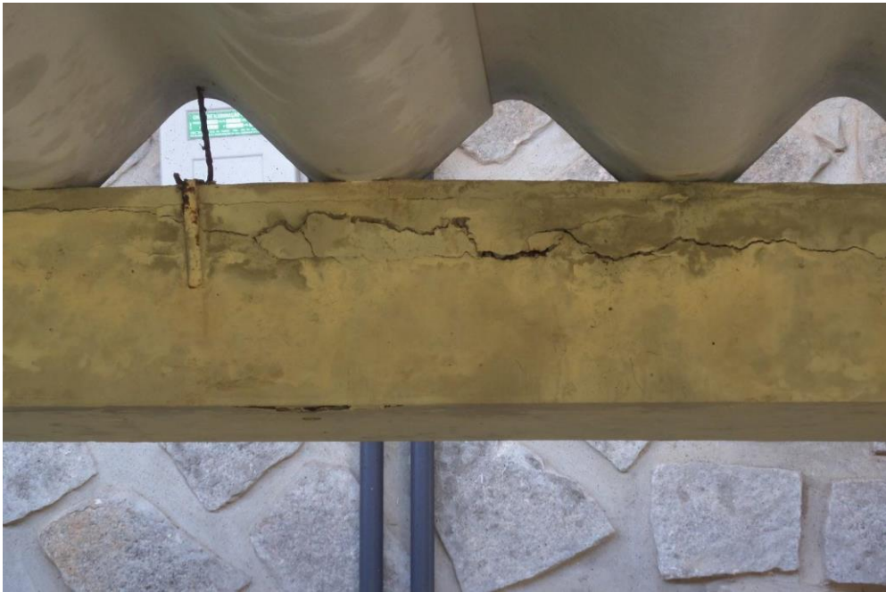
Figura 6 - Fissura no elemento estrutural
