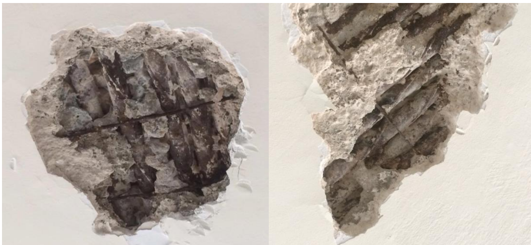
Figura 8 – Ausência de cobrimento
