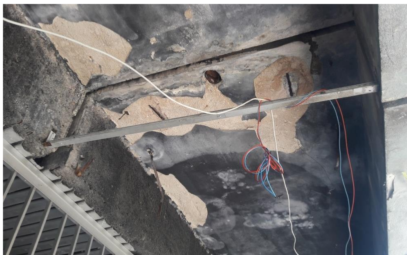
Figura 10 – Desagregação do concreto, manchas de umidade e corrosão da armadura
