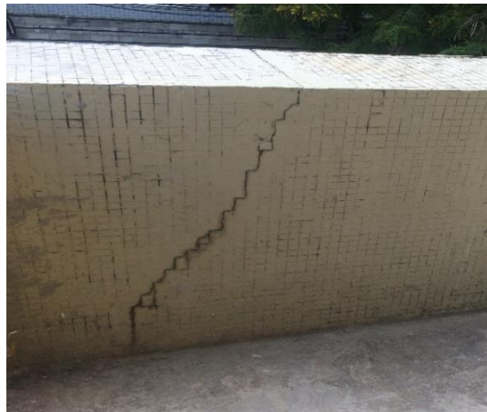
Figura 11 – Fissura na vinculação da marquise com a laje interna
