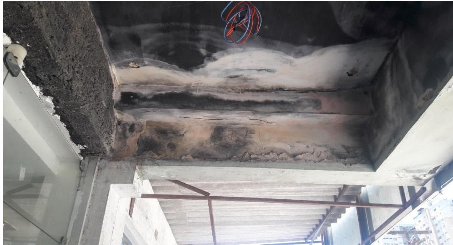
Figura 13 – Bolor e mancha de umidade
