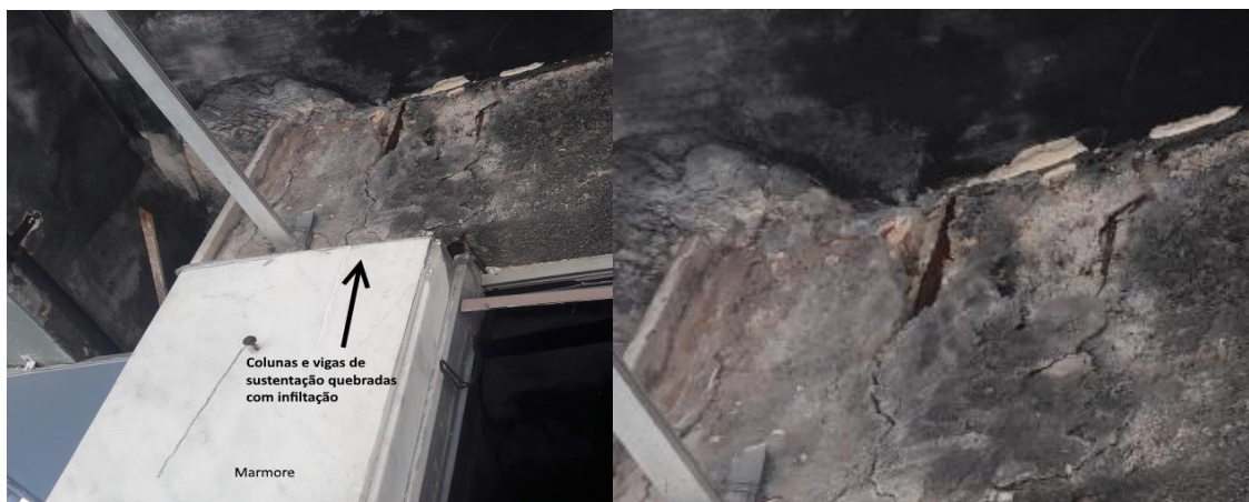
Figura 12 – Esmagamento da viga principal devido à sobrecarga
