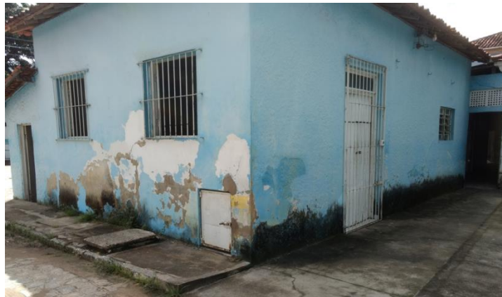
Figura 6 – Descascamento de pintura e bolor
