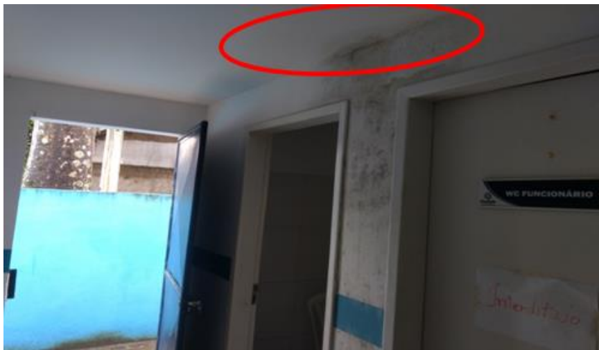
Figura 2- Mancha no forro de gesso devido a infiltração e a presença de bolor no teto e parede
