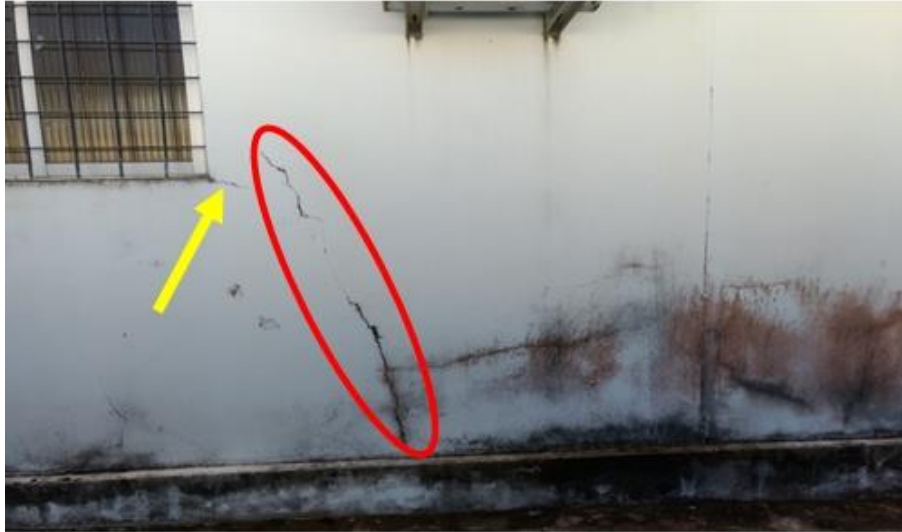
Figura 3 - Fissuras diagonais na área externa e a presença de bolor na extremidade
