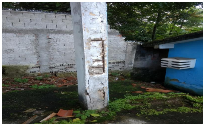
Figura 7 – Corrosão de armadura
