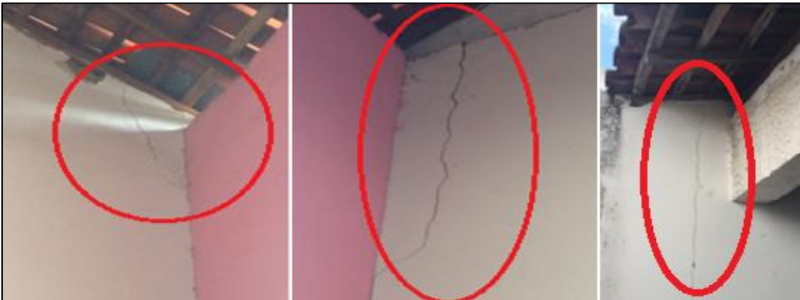
Figura 6 – Trincas e fissuras nas alvenarias
