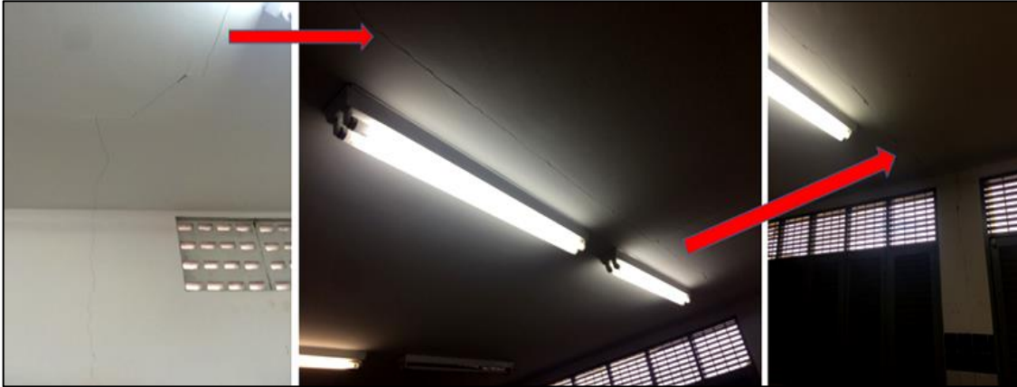
Figura 5 – Fissura em laje
