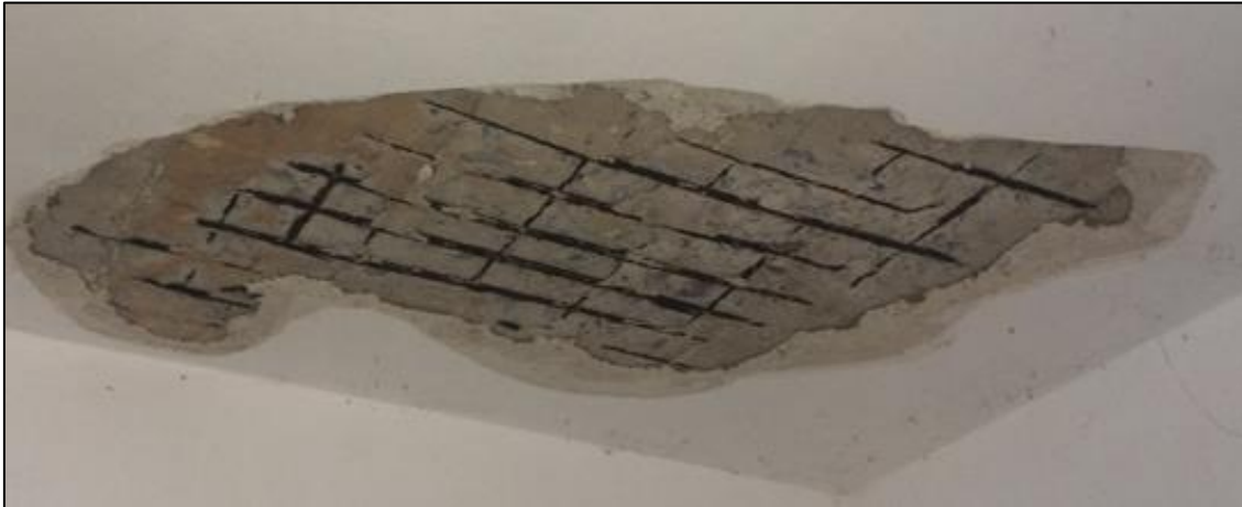
Figura 4 - Exposição da armadura da laje
