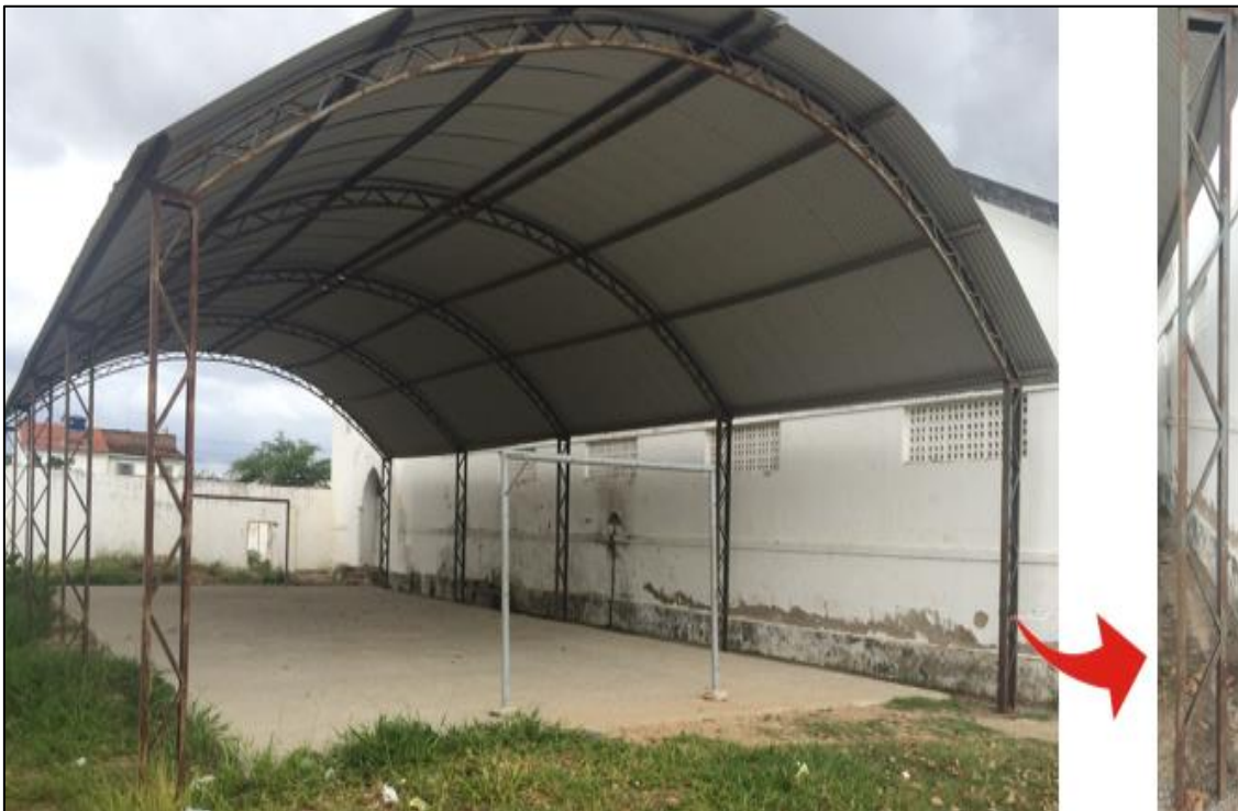
Figura 3 - Corrosão de estrutura metálica
