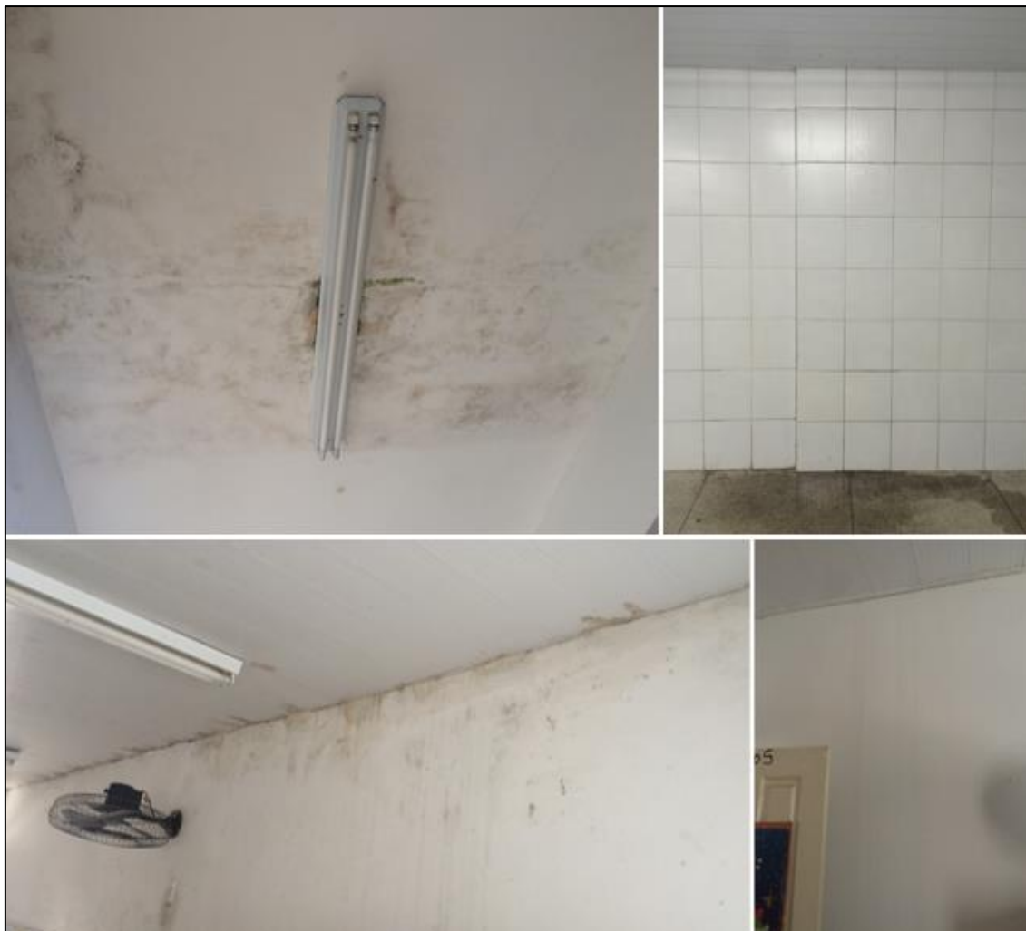
Figura 2 - Manchas no forro e infiltrações
