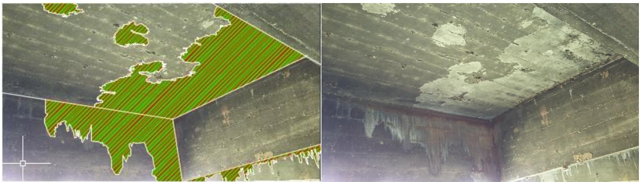
Figura 5 - Patologias representadas por manchas, encontradas na parte inferior da ponte.
