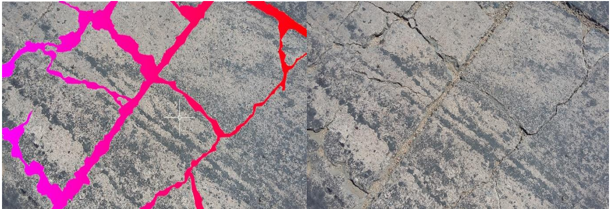
Figura 8 - Trincas em blocos no pavimento flexível que recobre a ponte.
