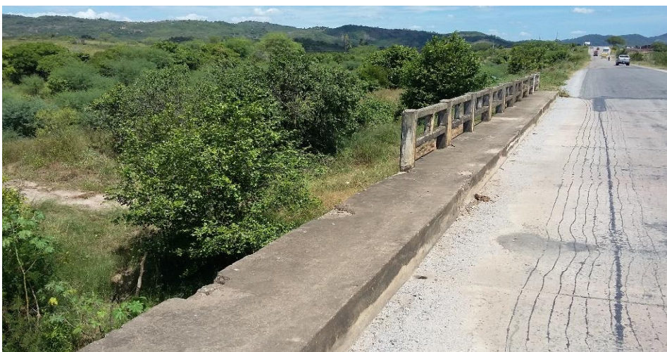
Figura 4 - Ausência de parte do guarda-corpo da ponte.
