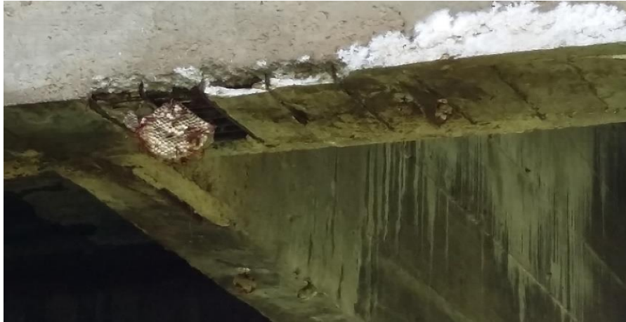
Figura 3 - Corrosão na armadura da viga longarina lateral
