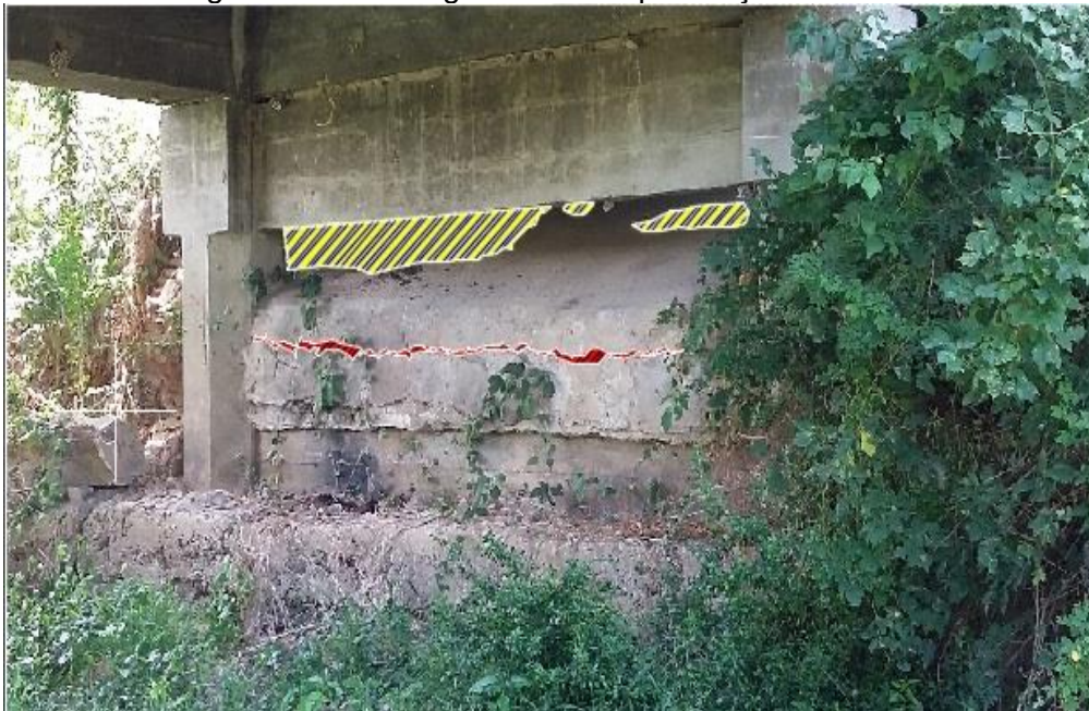
Figura 7 - Muro degradado com presença de fissura ilustrada .
