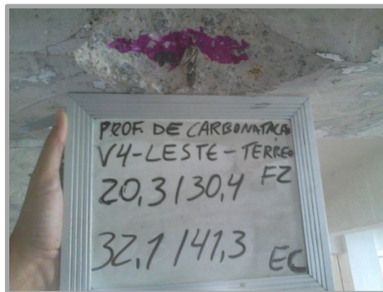
Figura 3 –Ensaio de espessura de carbonatação/cobrimento de concreto – Fonte Próprio Autor
