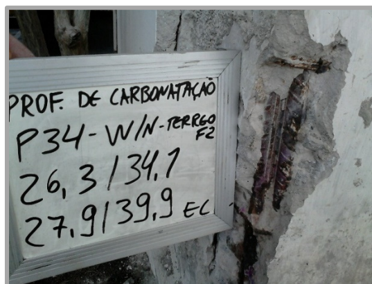
Figura 4 –Ensaio de espessura de carbonatação/cobrimento de concreto – Fonte Próprio Autor
