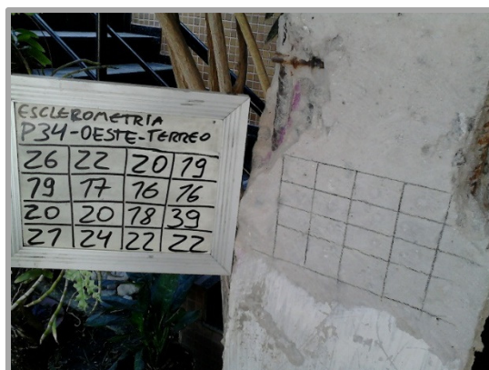
Figura 5 –Detalhe do ensaio de esclerometria (esquerda pilar, direita viga) – Fonte Próprio Autor
