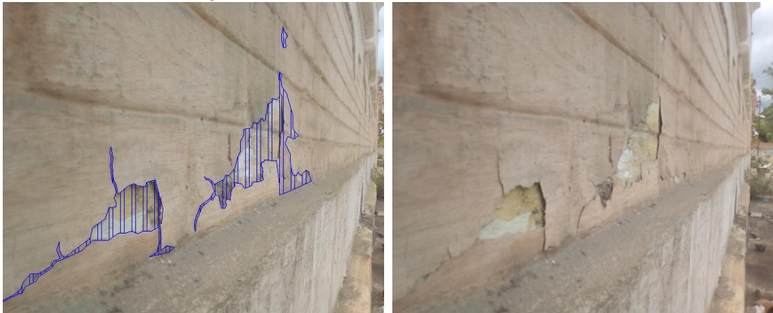
Figura 4 – Descascamento de pintura
