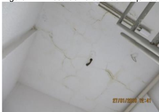
Figura 14 - Fissuras na sala de máquinas
