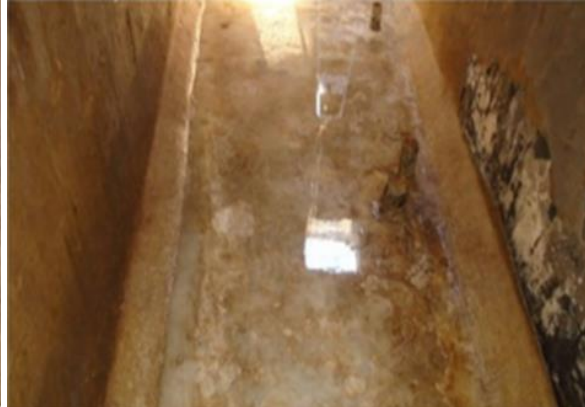
Figura 8 – Corrosão das armaduras
