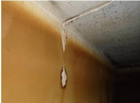
Figura 5 – Eflorescências em paredes
