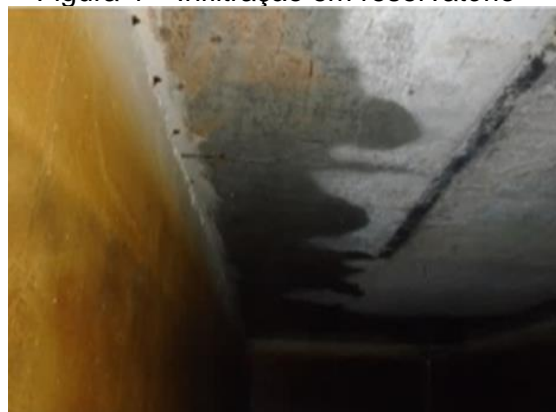
Figura 4 – Infiltração em reservatório
