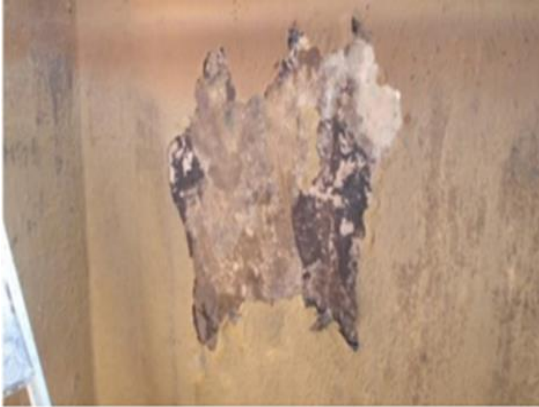
Figura 7 – Destacamentos do concreto
