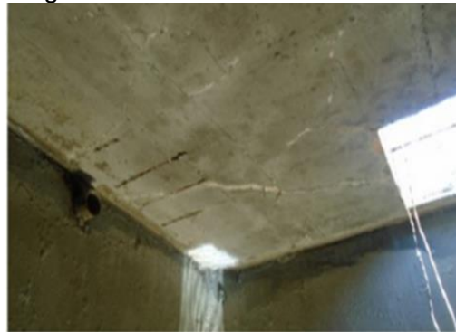
Figura 2 – Corrosão nas armaduras
