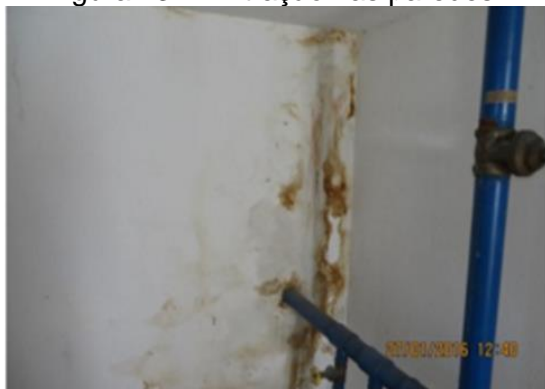
Figura 13 - Infiltração nas paredes
