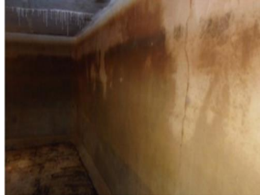
Figura 6 – Fissuras em paredes
