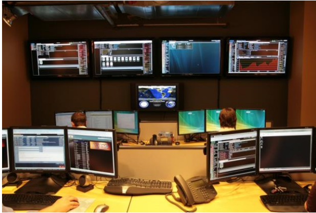
Figura 2 – Sala de Centro de Operações de Rede [5].
