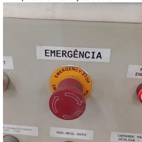
Figura 12 – Botoeira de emergência da linha de pintura em condições de uso.
