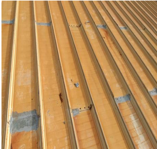
Figura 21 – Telhado do Galpão da ciclagem com pontos de vazamento corrigidos.
