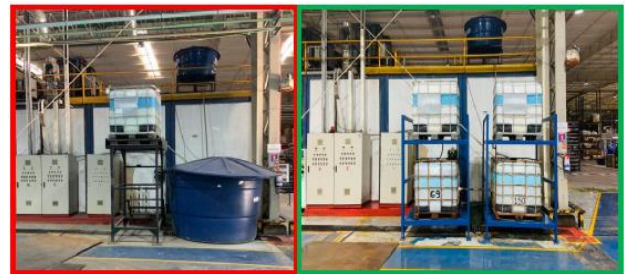
Figura 9 – Antes e depois modificação das caixas de refrigeração das estufas
