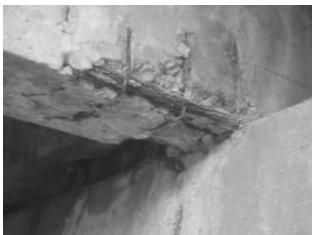
Figura 14: Detalhe do apoio da longarina sobre o encontro do lado oposto aos pêndulos, indicando tratar-se de chapas de chumbo ou a ausência de aparelhos de apoio pela destruição por esmagamento do concreto em zona de compressão.
