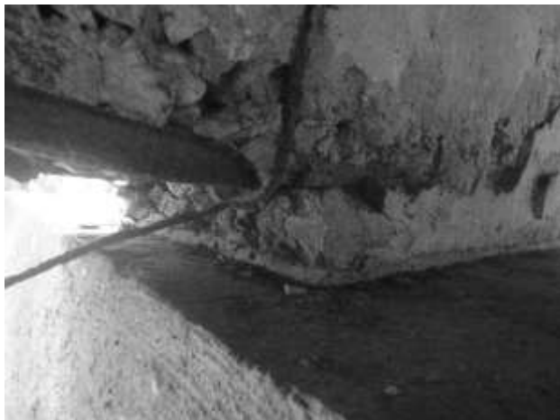
Figura 13: Detalhe do apoio central das longarinas, presumindo ser do tipo chapa de chumbo ou a inexistência de aparelho de apoio.
