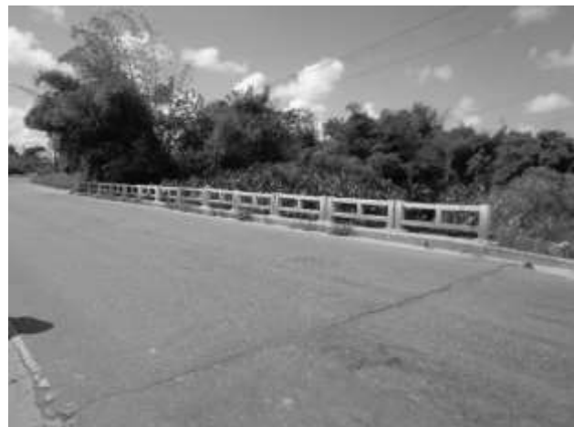
Figura 4: Ausência de junta e de passeios
