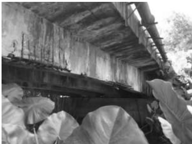
Figura 5: Ausência de pingadeira, contribuindo para o aparecimento de manchas no concreto e de corrosão nas armaduras
