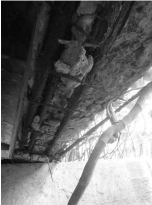
Figura 9: Situação da maior gravidade na face inferior de uma das longarinas extremas, com destruição total das armaduras e do concreto.
