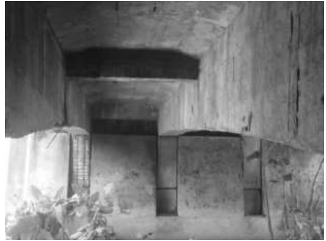
Figura 10: Pêndulo que apoia viga extrema com corrosão e destacamento do concreto.
