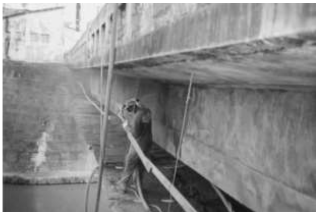
Figura 17: Exemplo da aplicação de concreto projetado no reforço das longarinas de uma ponte.
