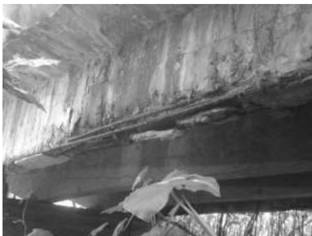
Figura 6: Vista de uma longarina extrema, mostrando as armaduras de flexão sem aderência e estribos destruídos.
