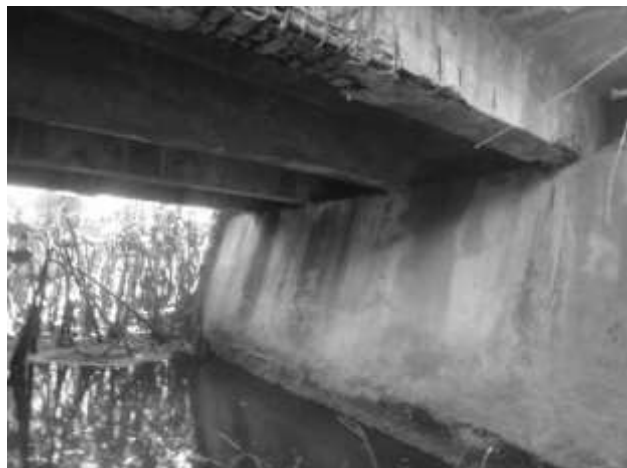
Figura 12: Os encontros apresentam manchas, mas não tem sinais de fissuras e deslocamentos.
