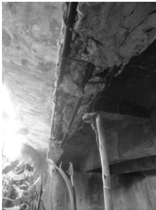
Figura 7: Perda total de aderência das armaduras e destruição do concreto.
