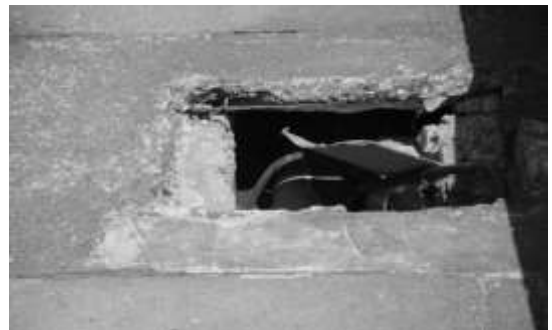
Figura 12 - Ausência da tampa da caixa de inspeção da fiação elétrica, representando situação de risco aos pedestres.
