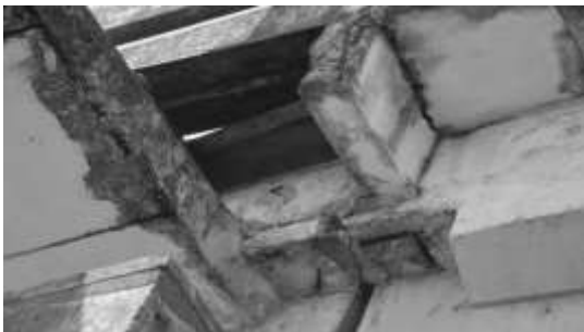
Figura 8 - Parte inferior do passeio e console de apoio das placas pré-moldadas com estrutura em estado de degradação.
