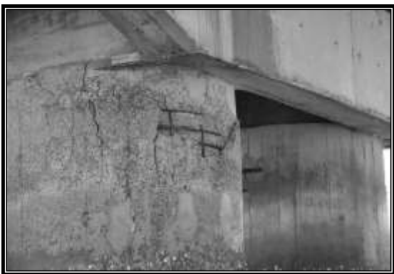
Figura 18- Grandes fissuras, corrosão de armaduras e sinais de lixiviação nos pilares.
