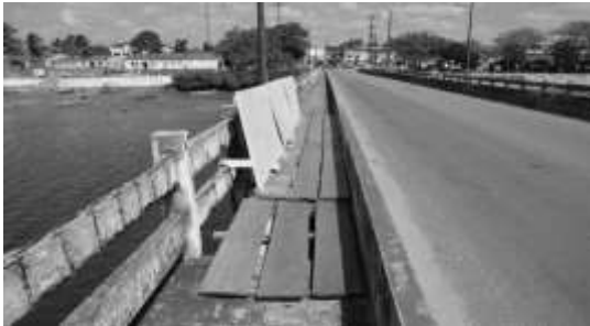
Figura 7 - Tábuas no passeio, assentadas em substituição às placas e guarda-corpos destruídos, caracterizando situação de alto risco para os pedestres.
