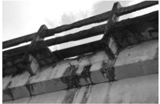
Figura 9 - Parte inferior do guarda-corpo e console em avançado estado de deterioração.
