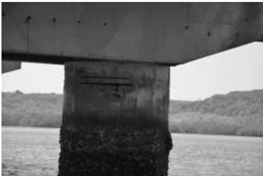
Figura 14 - Oxidação de armaduras de pilares em estado avançado, com deslocamento do concreto. Grande incrustação de moluscos no trecho de variação da maré
