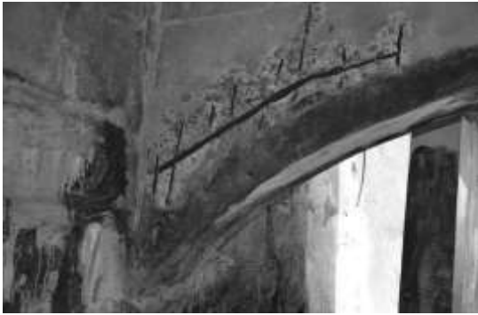
Figura 13 - Oxidação de armaduras e deslocamento do concreto nas longarinas originais
