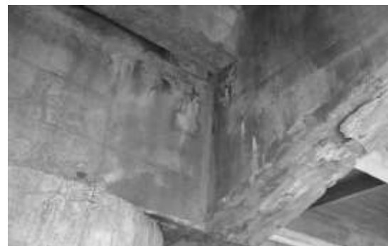
Figura 17 - Fissuras e deslocamento do concreto nos trechos centrais das travessas
