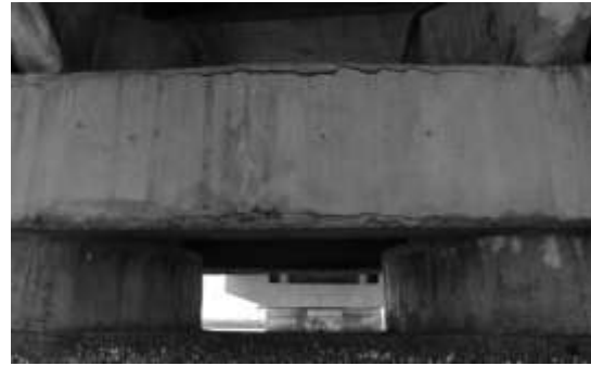
Figura 15 - Fissuras nas travessas causadas pela expansão de armaduras.
