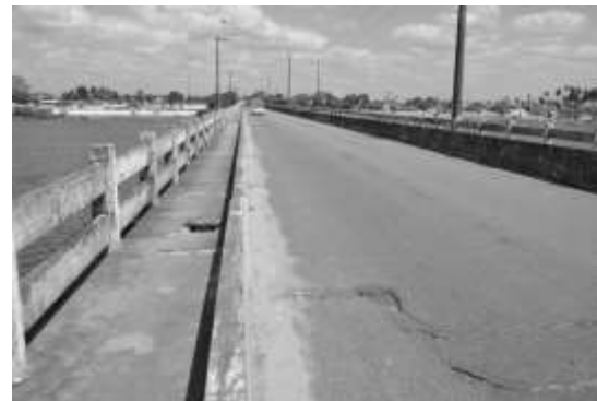
Figura 4- Danos na pavimentação.
