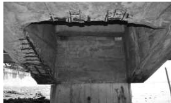
Figura 16 - Travessas de apoio dos passeios de pedestres, com avançado estado de corrosão de armaduras e deslocamento do concreto.
