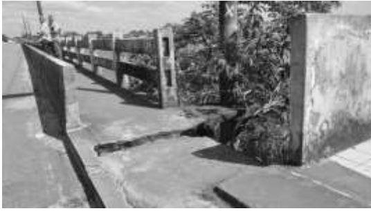
Figura 5 - Desnível na ligação entre a ponte e o aterro, significando também uma situação de risco aos pedestres.
