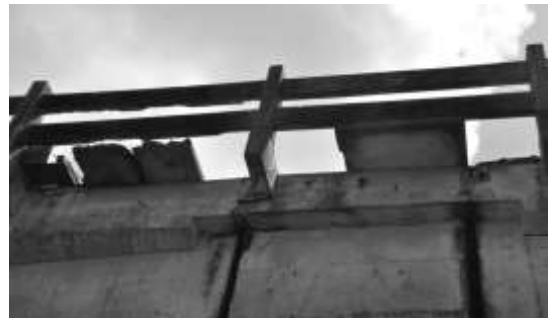
Figura 10 - Placas pré-moldadas em balanço com estrutura completamente degradada e console comprometido.
