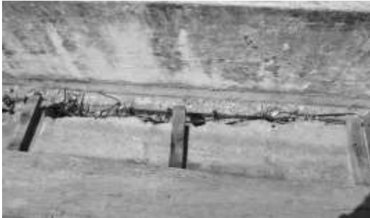
Figura 6 - Armaduras destruídas nas placas do passeio
