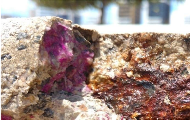
Figura 7: Detalhe de parte contaminada pelo dióxido de carbono.
