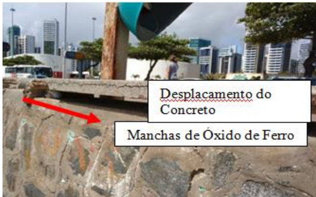
Figura 3: Deslocamento na parte de apoio do banco
