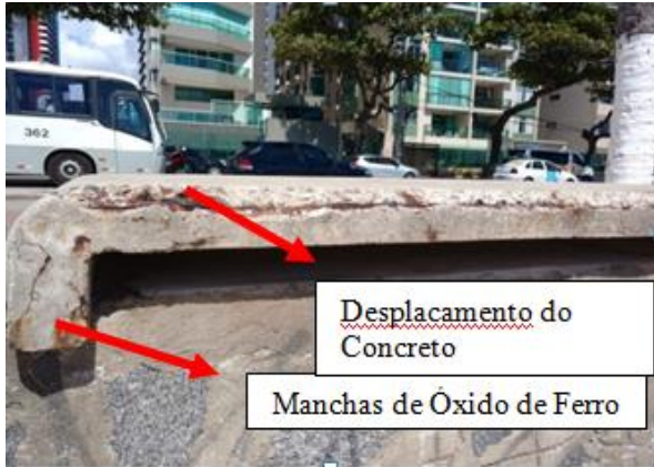
Figura 2: Deslocamento na parte superior do banco
