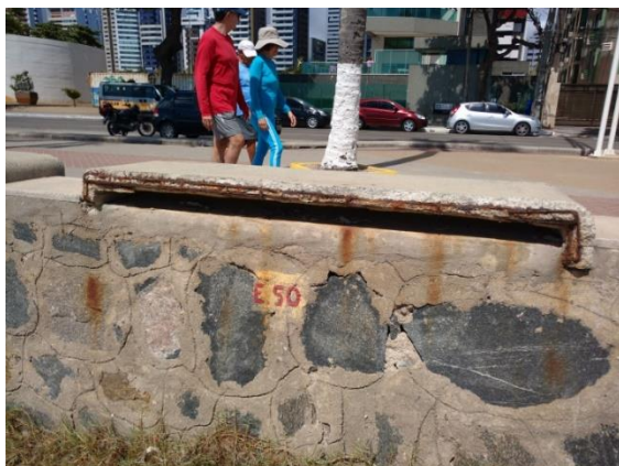
Figura 5: Evidência de corrosão em bancos adjacentes
