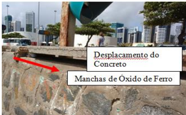
Figura 3: Desplacamento na parte de apoio do banco Fonte: Os autores.
