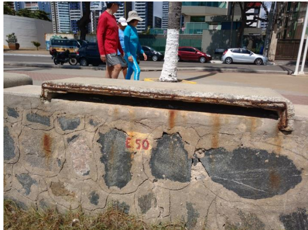
Figura 5: Evidência de corrosão em bancos adjacentes Fonte: Os autores.
