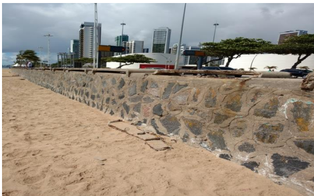
Figura 4: Evidência do Colapso da estrutura. Fonte: Os autores.
