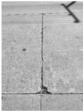
Foto 2: Falha na selagem das juntas e quebra de canto
