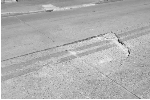
Foto 1: Quebras localizadas e desgaste superficial
