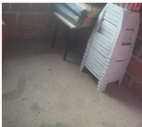
Figura 2: Ausência de piso. Fonte: Elaborado pelo autor (2015).
