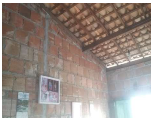
Figura 3: Ausência de reboco. Fonte: Elaborado pelo autor (2015).
