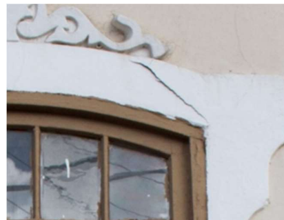
Figura 5: Abertura no arco da esquadria.
