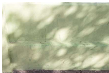
Figura 8: Manchas de umidade e aberturas. Fonte: Autores (2017).
