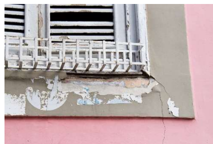
Figura 16: Descolamento de revestimento e aberturas no canto da esquadria. Fonte: Autores (2017).
