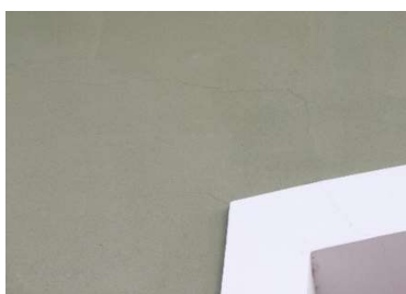
Figura 20: Fissuras nos cantos dos arcos das portas. Fonte: Autores (2017).
