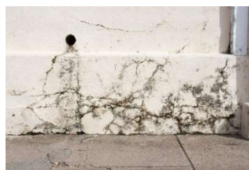
Figura 4: Manchas de lodo e aberturas.
