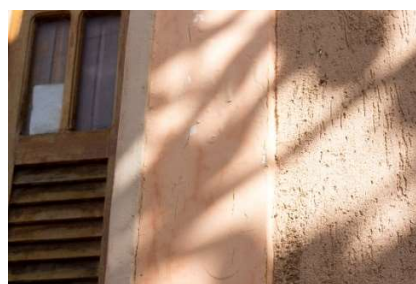
Figura 11: Manchas de umidade, empolamento e aberturas no revestimento. Fonte: Autores (2017).
