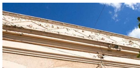
Figura 12: Desagregamento. Fonte: Autores (2017).
