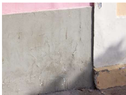
Figura 15: Manchas de umidade, vesículas e aberturas. Fonte: Autores (2017).
