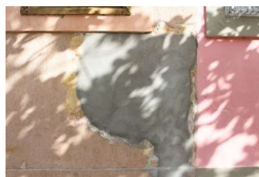
Figura 10: Ausência de revestimento. Fonte: Autores (2017).
