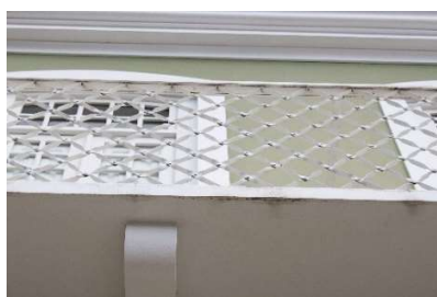
Figura 21: Manchas de lodo na marquise. Fonte: Autores (2017).
