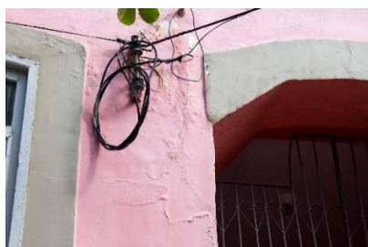
Figura 14: Vesículas recorrentes de acúmulo de umidade. Fonte: Autores (2017).
