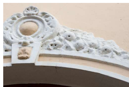
Figura 18: Fissuras no detalhe do arco da janela. Fonte: Autores (2017).
