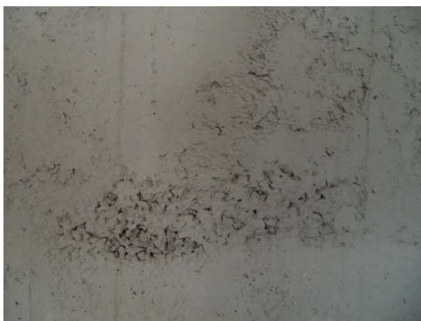
Figura 2: Segregação em parede de concreto armado. Fonte: Autores (2017).
