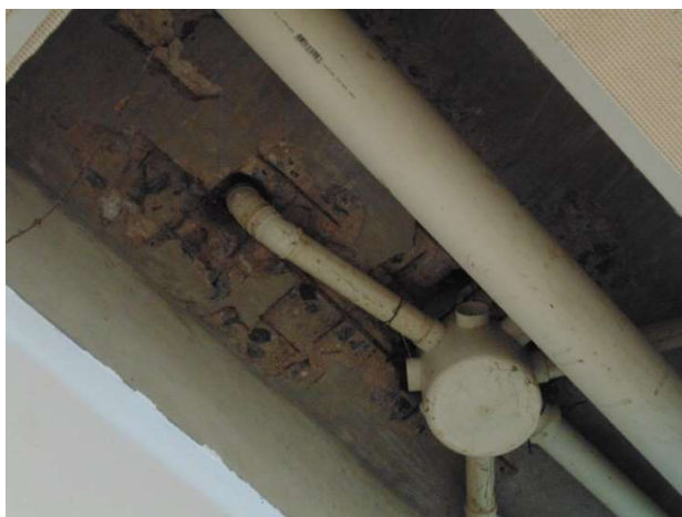
Figura 3: Corrosão de armadura e desagregação em laje de concreto armado. Fonte: Autores (2017).
