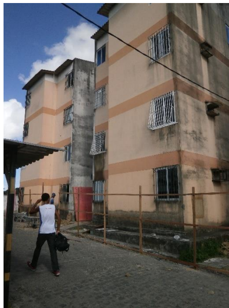
Foto 02: Degradação da Fachada.
