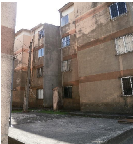
Foto 01: Degradação da Fachada
