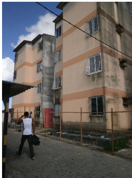
Foto 02: Degradação da Fachada.
