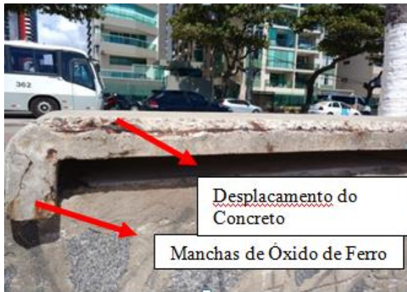
Figura 2: Desplacamento na parte superior do banco Fonte: Os autores.
