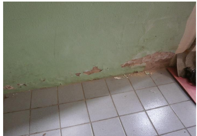
Foto 06: Infiltração por ascensão capilar
