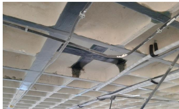
Figura 15: Local onde houve o corte da nervura devido a instalação do ar condicionado central, reforçado com fibra de carbono
