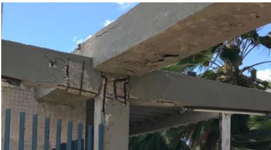
Figura 1 – Estrutura de concreto armado com nível avançado de corrosão.
