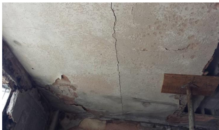
Figura 7- Parede do quarto, danos no reboco e argamassa de revestimento
