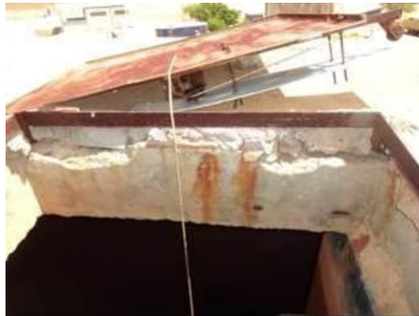
Figura 12 – Corrosão na tampa e desagregação do concreto na entrada do reservatório.
