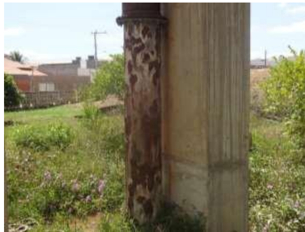
Figura 7 – Corrosão das tubulações.
