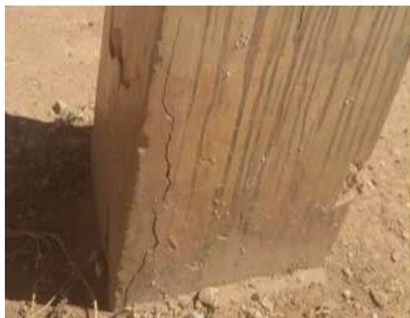
Figura 17 – Fissuras nos pilares e desagregação do concreto.
