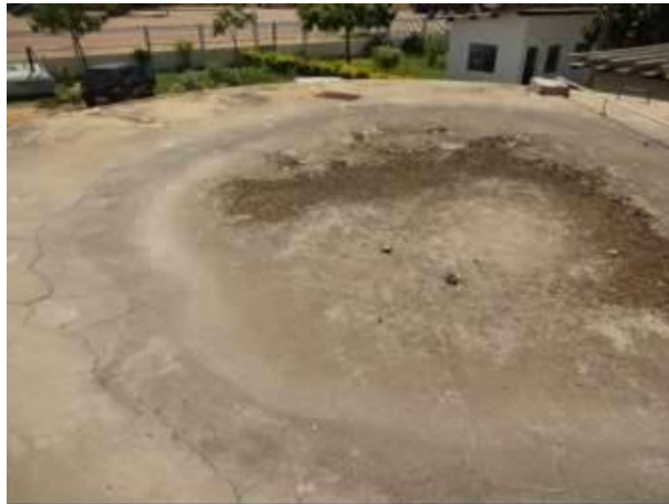
Figura 15 – Afundamento da laje da tampa do reservatório.
