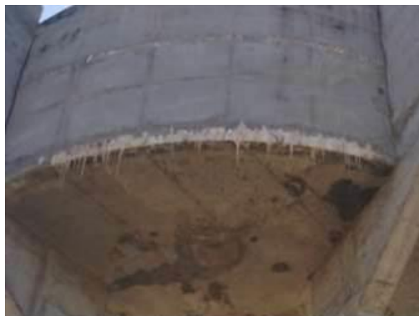
Figura 8 – Lixiviação com formação de estalactites devido a deficiência da impermeabilização.
