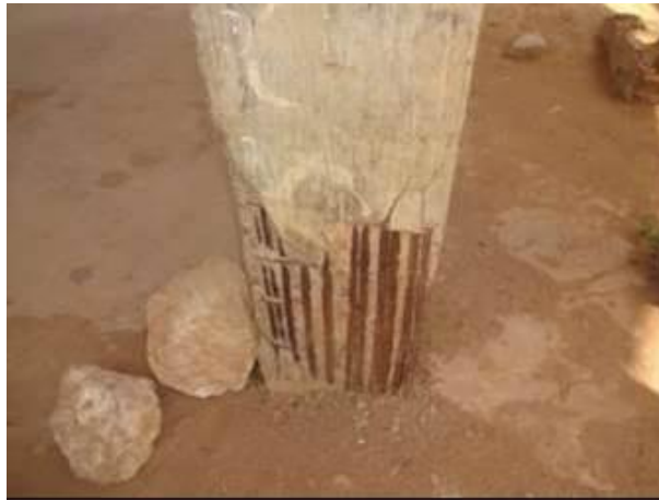
Figura 18 – Desagregação e armadura aparente nos pilares.
