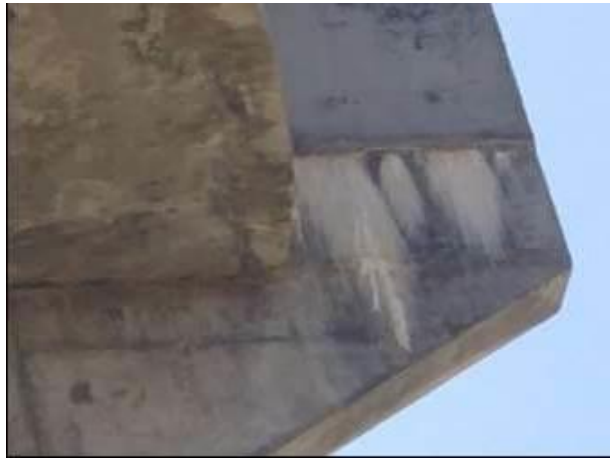
Figura 9 – Carbonatação na junção dos premoldados.
