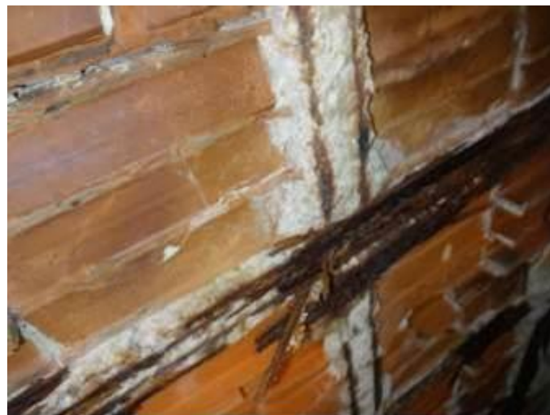
Figura 16 – Deslocamento da laje superior na fase interna do reservatório e corrosão acentuada das armaduras.
