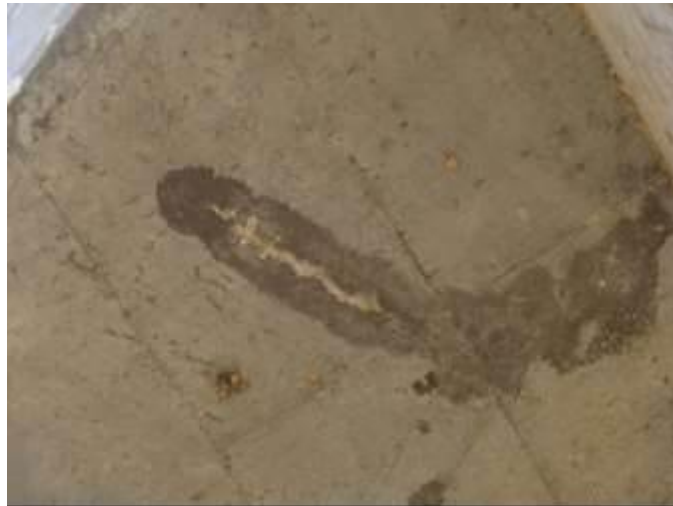
Figura 10 – Indício de infiltração.
