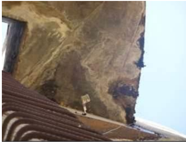
Figura 6 – Carbonatação e manchas escuras devido a percolação da água.
