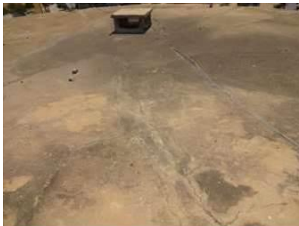
Figura 11 – Trincas na face superior da laje de tampa do reservatório.
