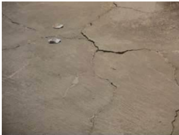
Figura 14 – Trincas na laje da tampa do reservatório semi-enterrado.
