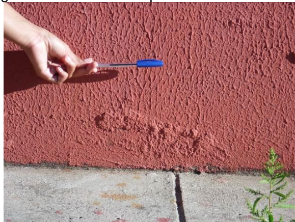
Figura 7 – Vesículas na parte inferior da fachada.
