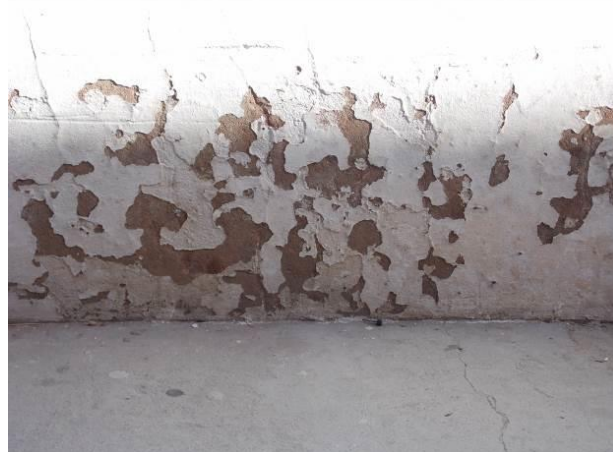
Figura 5 – Descascamento de pintura do muro.
