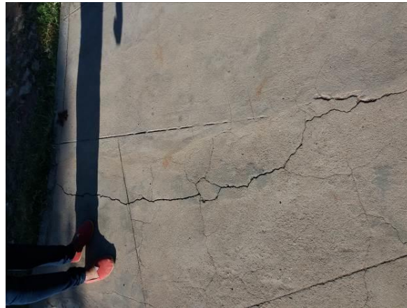
Figura 11 –Trinca no piso cimentado.
