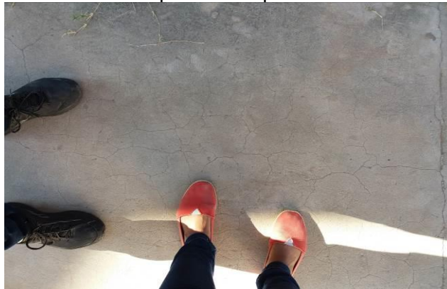
Figura 10 – Fissuras mapeadas no piso cimentado de concreto.
