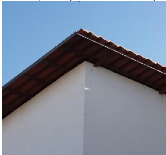
Figura 12 – Trinca na parte superior da alvenaria a partir do telhado.
