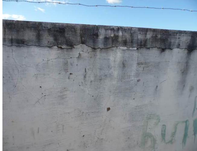
Figura 8 – Fissura horizontal e fissuras mapeadas.
