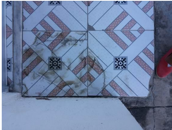
Figura 6 – Revestimento cerâmico rachado e com presença de umidade
