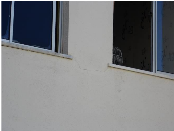
Figura 9 – Trincas nas bases das esquadrias.
