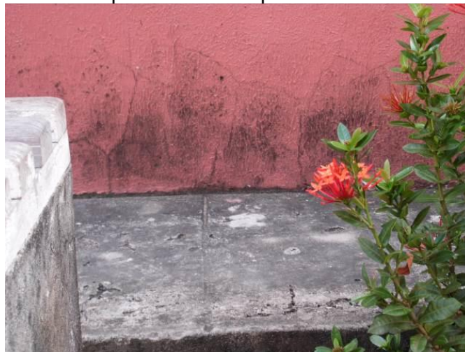
Figura 3 – Bolor na parte inferior da parede e fissuras ascendentes.
