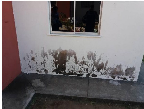
Figura 4 – Ascensão capilar na parte inferior da parede
