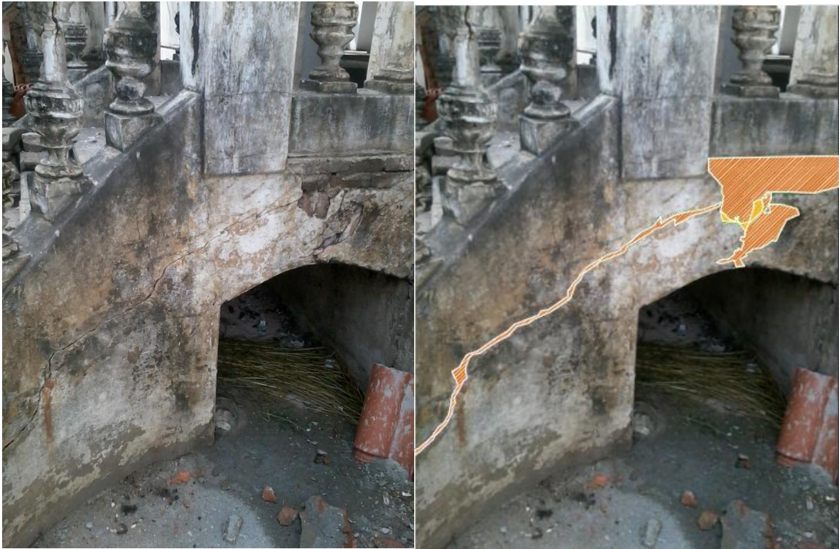
Figura 9 - a) Rachadura na região lateral da escada. b) Mapeamento das manifestações patológicas com auxílio do Auto-Cad.
