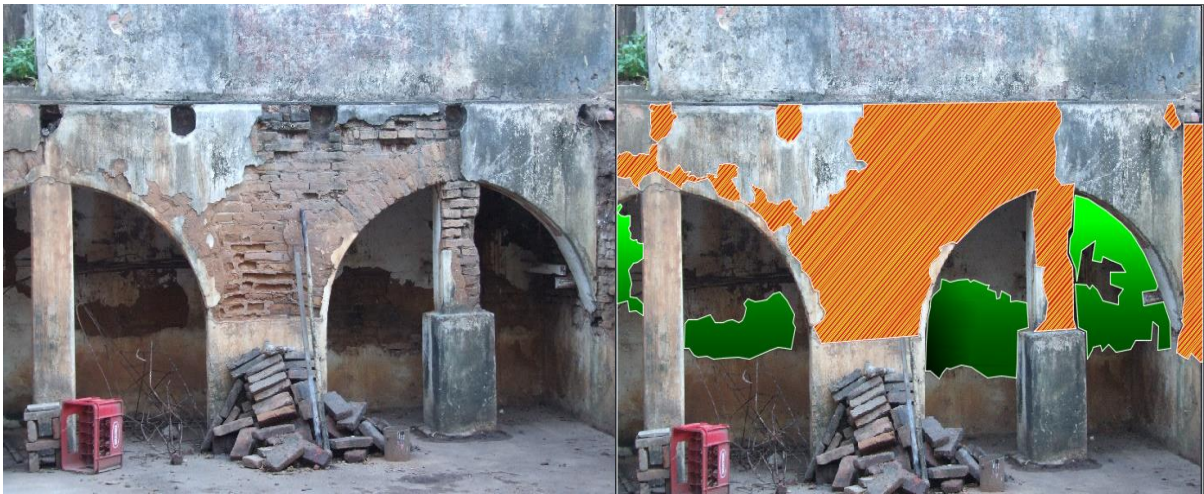
Figura 5 - a) Degradação quase total da alvenaria externa. b) Mapeamento das manifestações patológicas com auxílio do Auto-Cad.
