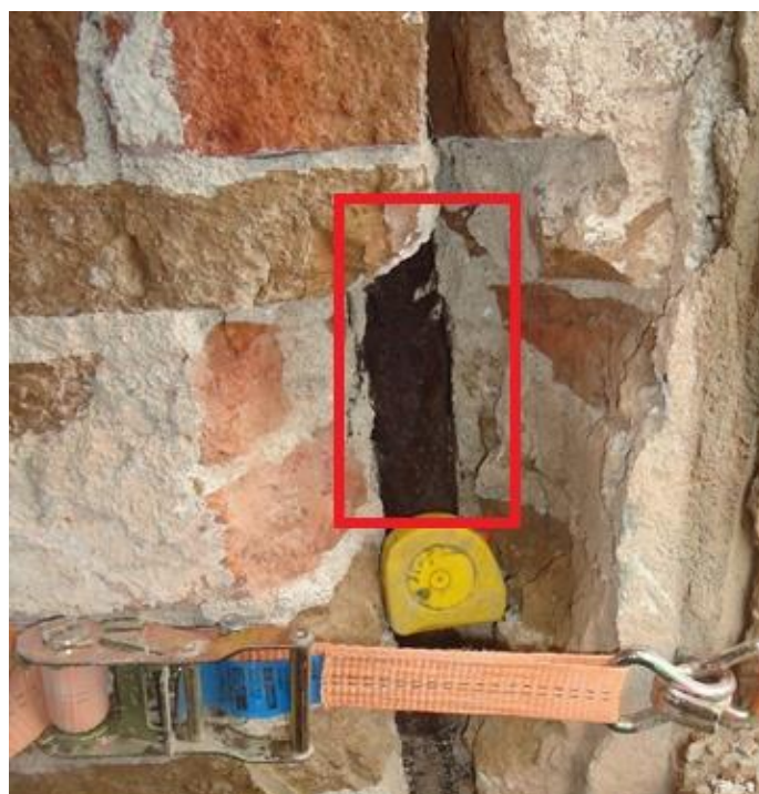
Figura 4 – Barra de Aço Dentro da Coluna da Torre Epístola
