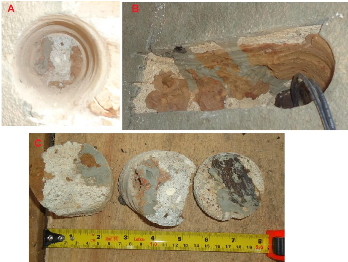
Figura 9- A – Abertura realizada com a Serra Copo mostrando que as rachaduras estavam preenchidas com cimento; B – Abertura feita na coluna mostrando que as rachaduras estavam preenchidas com cimento; C – Amostras Removidas das Colunas com Serra Copo.
