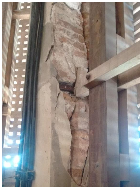
Figura 3 - Rachaduras em uma das Colunas da Torre Epístola
