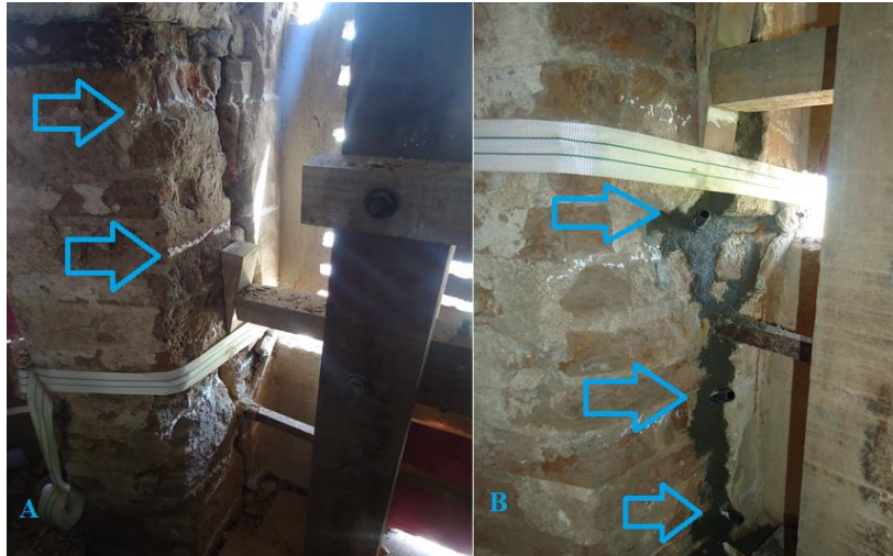
Figura 5 - A- Marcação para Purgadores; B- Indicação dos Purgadores
