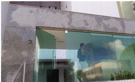
Figura 16 – Manchas de umidade em revestimento
