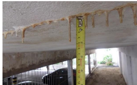
Figura 4 – Lixiviação com presença de estalactites sob a laje da quadra
