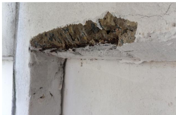
Figura 2 – Destacamento do cobrimento em estrutura da quadra poliesportiva
