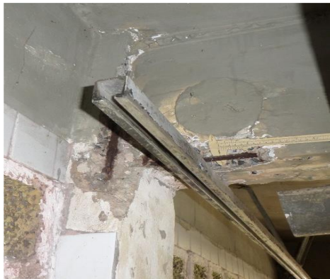
Figura 1 – Exposição de armaduras no subsolo
