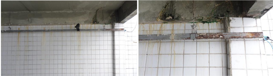
Figura 6 – Lixiviação, eflorescência, bolor e corrosão no concreto em parede do reservatório inferior no subsolo
