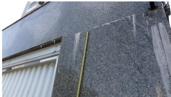
Figura 17 – Lixiviação em revestimento
