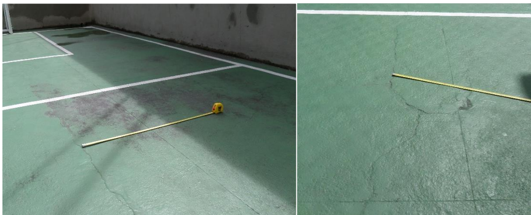
Figura 5 – Manchas de umidade, fissuras e trincas no piso da quadra
