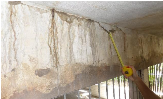
Figura 3 – Lixiviação e exposição de armadura em viga sob a quadra
