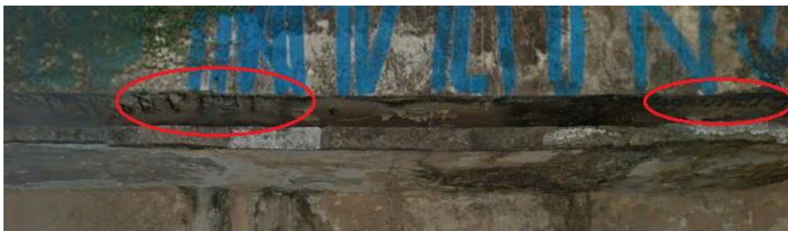
Figura 7: Estado de conservação das armaduras da marquise.
