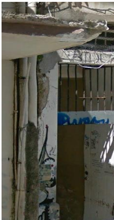
Figura 3: Tubulação de água.
