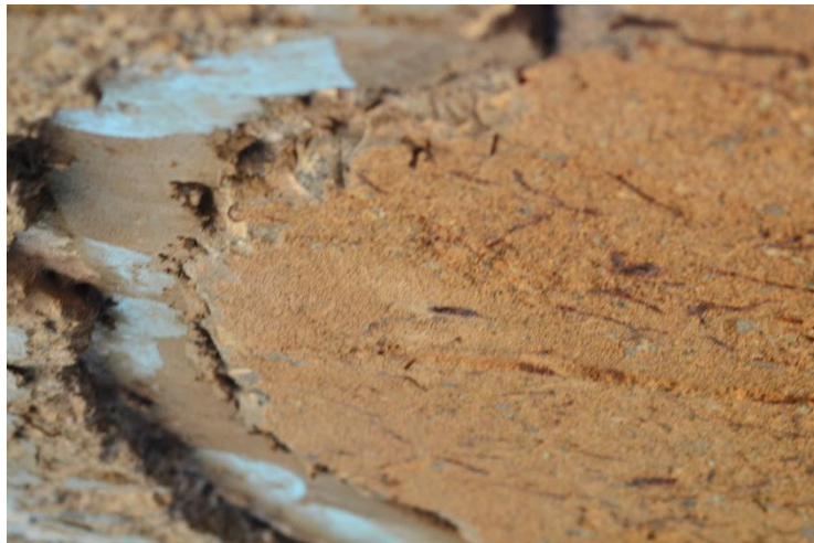
Figura 15 – Falta de união entre os concretos no bloco de fundação
