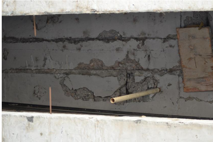
Figura 4 – Vista geral do desgaste na parte inferior da laje da ponte
