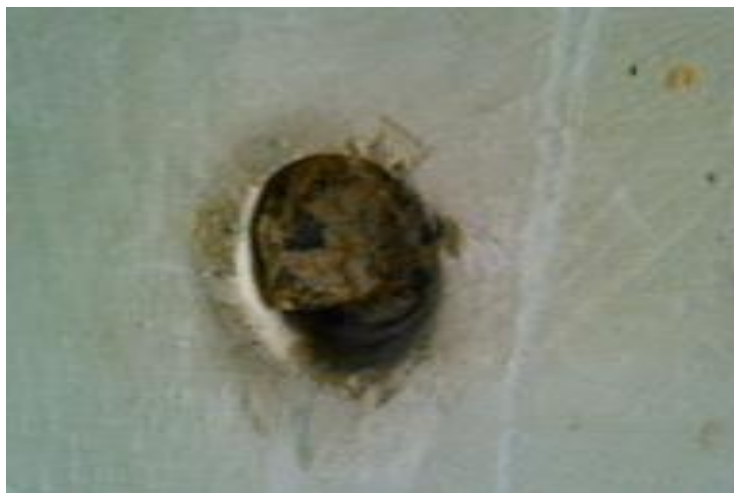
Figura 17 – Detalhe do ensaio no bloco de fundação com indicio de carbonatação
