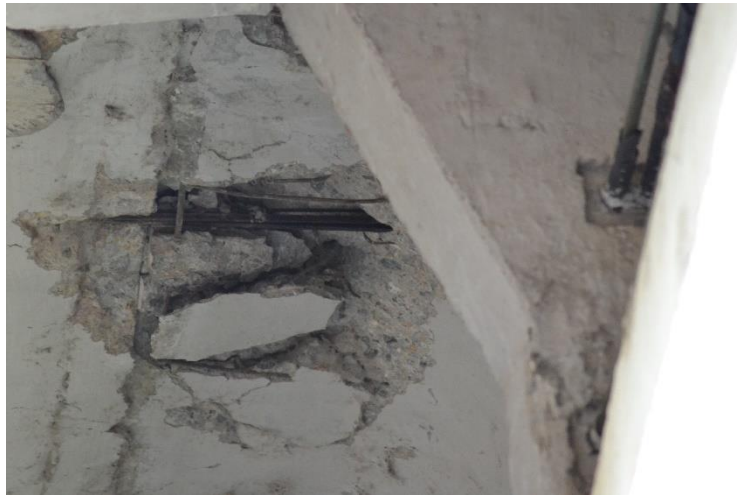
Figura 6 – Armadura exposta em ponto localizado da laje com principio de corrosão
