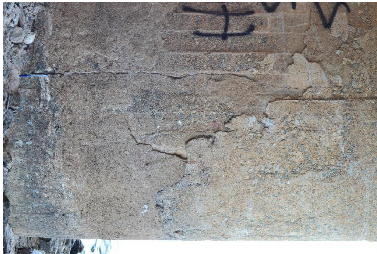
Figura 13 – Desgaste por abrasão no elemento de concreto armado
