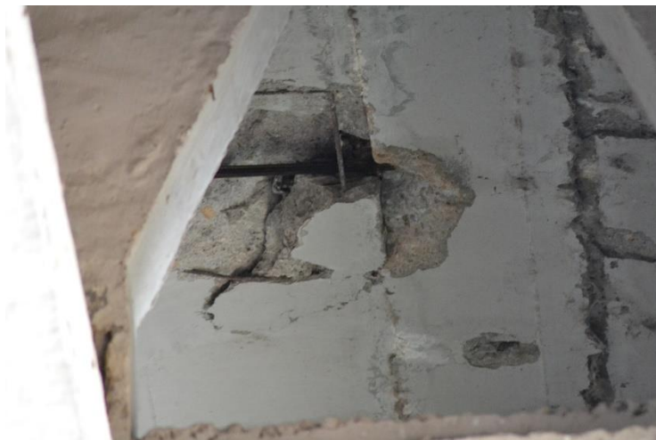
Figura 5 – Armadura exposta em ponto localizado da laje
