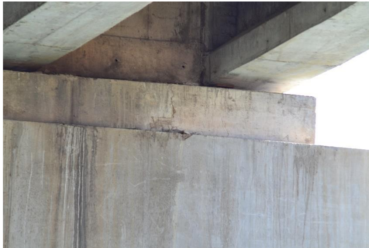
Figura 8 – Eflorescência no bloco de coroamento das estacas
