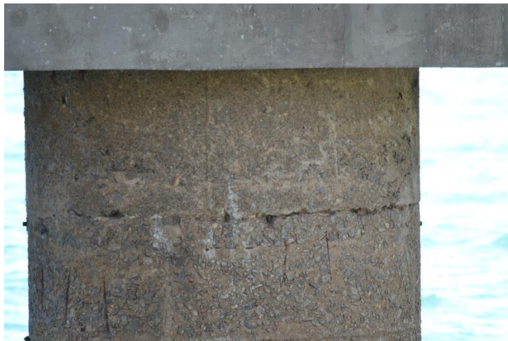
Figura 11 – Trincas no elemtno de fundação em concreto armado
