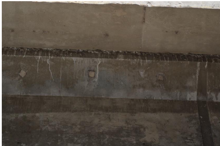
Figura 9 – Eflorescência na parte inferior da laje
