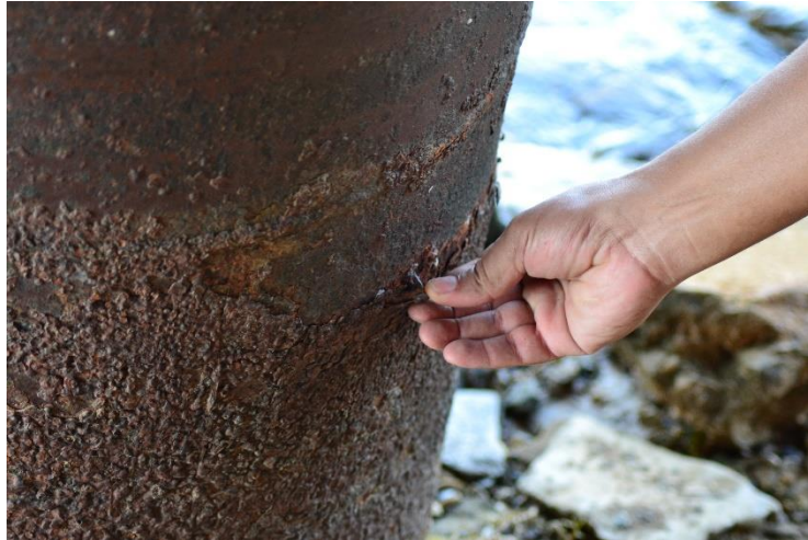
Figura 14 – Corrosão e deslocamento no tubulão metálico
