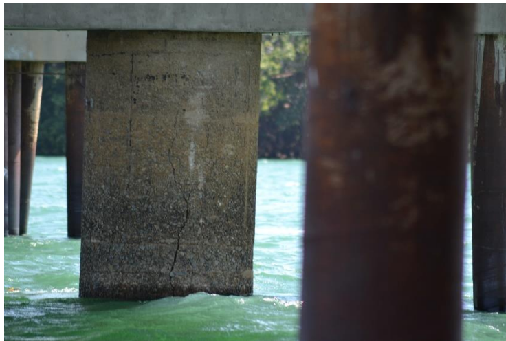
Figura 12 – Trincas no elemento de fundação em concreto armado, vista em outro elemento
