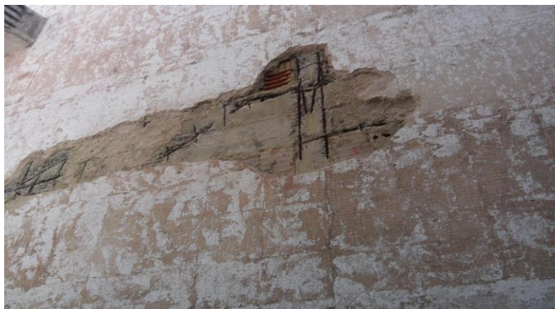
Figura 4- Deteriorização do concreto
