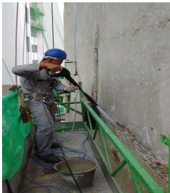
Figura 5- Tratamento das fissuras
