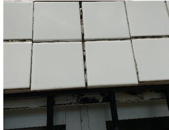
Figura 6. Falha no rejuntamento
