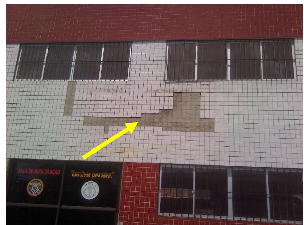
Figura 8. Descolamento de cerâmica em fachada
