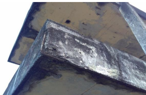
Figura 4: Lixiviação, tubo de dreno entupido. Fonte: Próprio Autor (2019).
