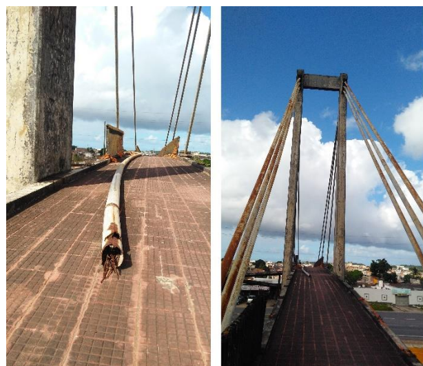
Figura 8: Corrosão de cabos de aço. Fonte: Próprio Autor (2019).
