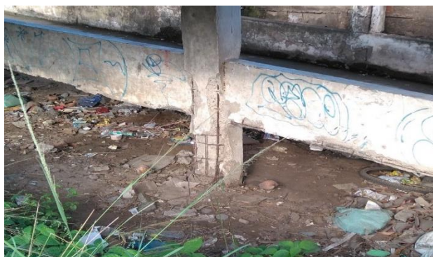
Figura 5: Corrosão de Armadura em pilar. Fonte: Próprio Autor (2019).
