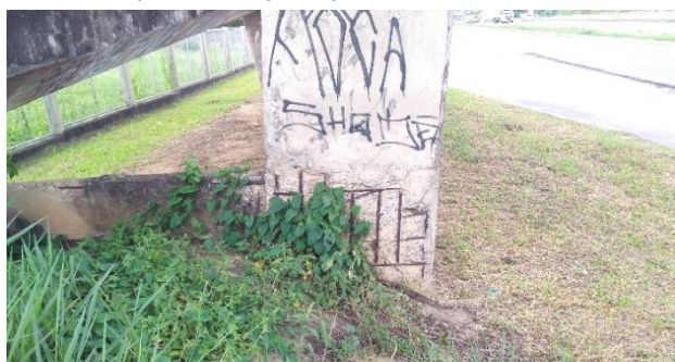
Figura 10: Corrosão de Armadura em pilar.
