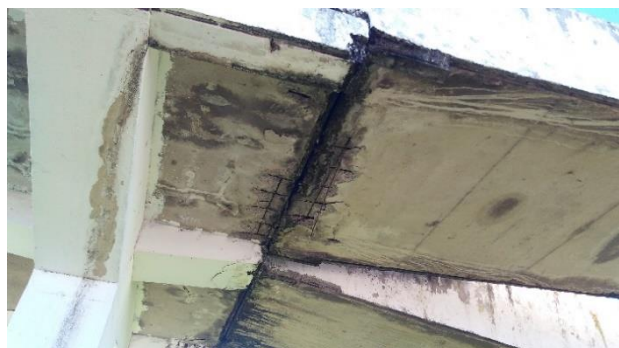
Figura 15: Falta de juntas e impermeabilização. Fonte: Próprio Autor (2019).
