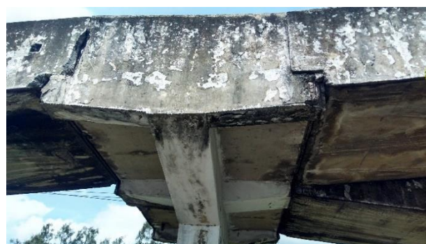
Figura 18: Estrutura com bastante infiltração nas juntas. Fonte: Próprio Autor (2019).
