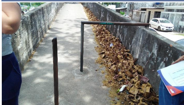
Figura 18: Folhas e lixo na parte superior das passarelas Fonte: Próprio Autor (2019).
