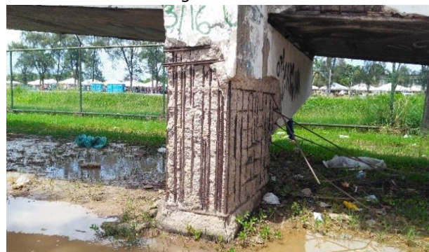
Figura 17: Corrosão de armadura em pilar. Fonte: Próprio Autor (2019).
