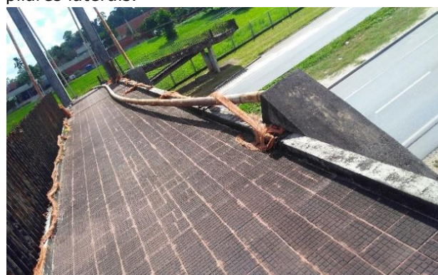
Figura 7: Cabo de aço rompido. Fonte: Próprio Autor (2019).
