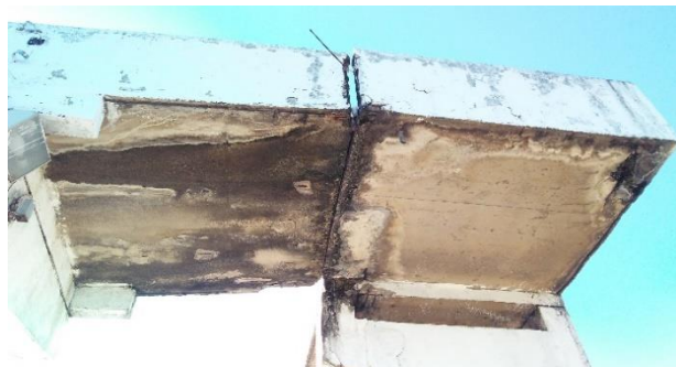
Figura 14: Lixiviação, corrosão e eflorescência.
