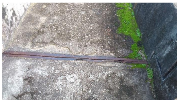
Figura 6: Fungos, vegetação junta deteriorada. Fonte: Próprio Autor (2019).
