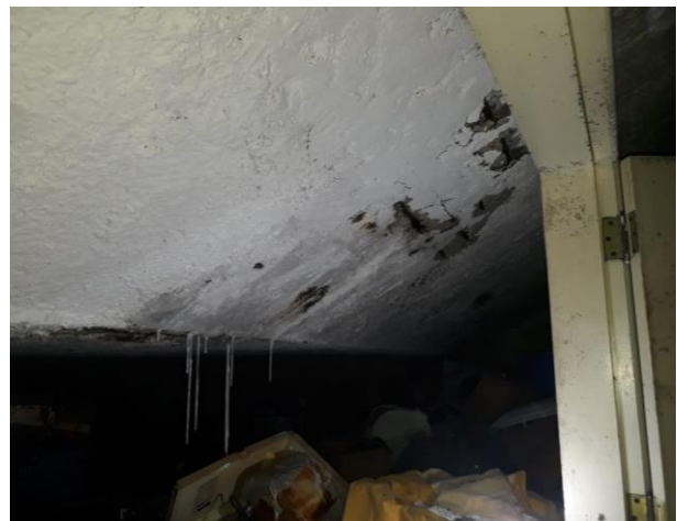
Figura 2: Corrosão de armadura com descolamento de cobertura de concreto, fissuras, eflorescência e estalactites identificados em piscina no Condomínio N. FONTE: AUTORES (2019).
