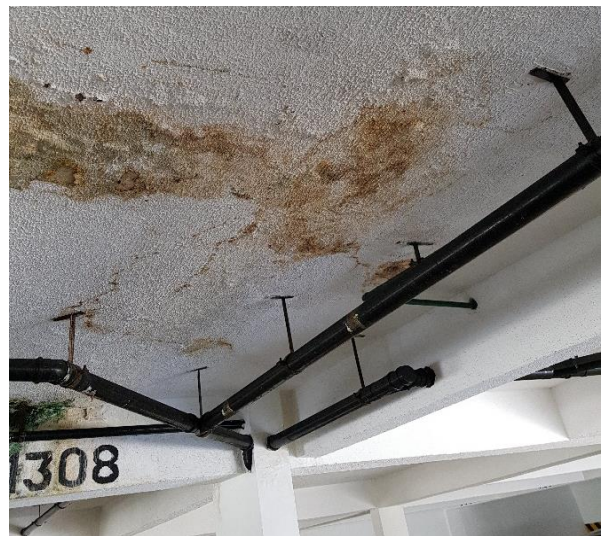
Figura 3: Manchas de umidade, fissuras e destacamento do revestimento, identificados em laje no Condomínio E. FONTE: AUTORES (2019).
