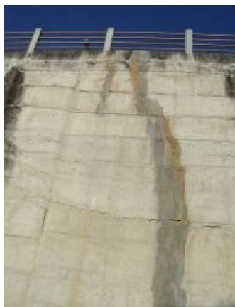
Foto 4: Trinca subvertical na laje vertical de montante, com 5,0 m de extensão e abertura obturada com argamassa, situada na ombreira direita. Fonte: DNOCS [9], 2011.
