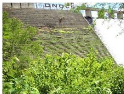
Foto 8: Vegetação nos degraus do talude de jusante da barragem, devido às infiltrações de água. Fonte: DNOCS [9], 2011.
