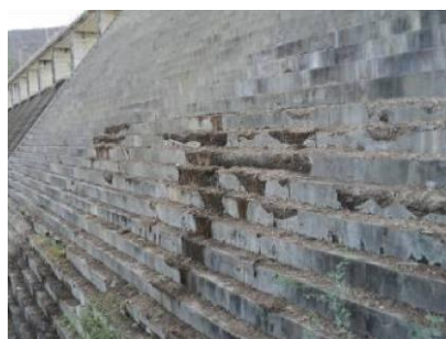
Foto 7: Degraus em concreto no trecho de jusante da barragem, na ombreira esquerda bastante umedecidos e desagregados. Fonte: DNOCS [9], 2011.
