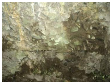
Foto 10: Fissura com 3,0 mm de abertura na parede da entrada da galeria, situada na ombreira esquerda. Fonte: DNOCS [9], 2011.
