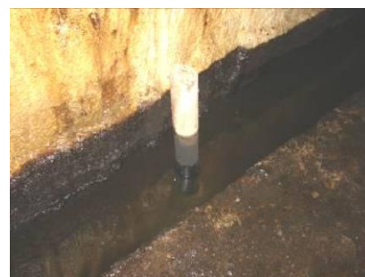
Figura 12: Detalhe de um poço de alívio danificado situado na valeta de drenagem da galeria no trecho central da barragem. Fonte: DNOCS [9], 2011.
