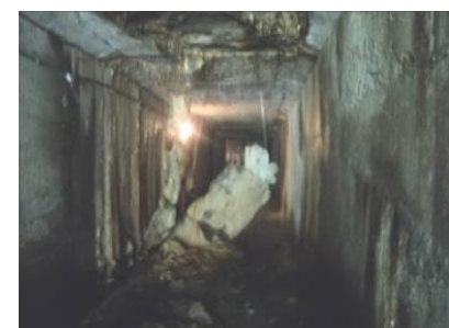
Figura 13: Detalhe de um poço de alívio danificado situado na valeta de drenagem da galeria no trecho central da barragem. Fonte: DNOCS [9], 2011.
