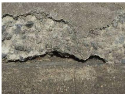
Foto 1: Detalhe da bexiga com a ferragem exposta a montante do creager do extravasor principal. Fonte: DNOCS [9], 2011
