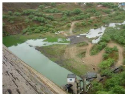
Foto 3: Vista do trecho imediatamente à jusante do extravasor, onde deverá ser recuperada a bacia de dissipação e implantada a estrutura em salto em esqui. Fonte: DNOCS [9], 2011.
