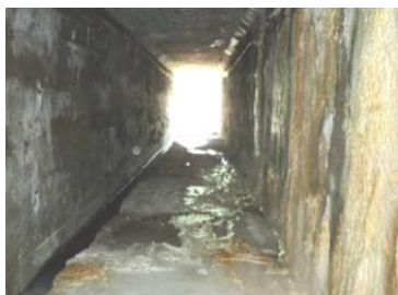
Foto 9: Entrada da galeria situada nas proximidades da ombreira esquerda, verificando-se desmoronamentos no teto e no lado esquerdo a valeta de saída das águas drenadas na galeria. Fonte: DNOCS [9], 2011.
