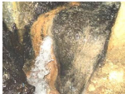
Figura 11: Surgência localizada de água na parede de montante da galeria situada na ombreira esquerda. Fonte: DNOCS [9], 2011.
