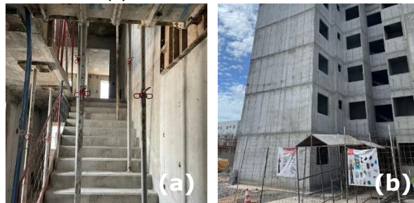
Figura 2 – Vista da (a) desmontagem das formas metálicas e (b) estrutura de concreto moldada in loco .
