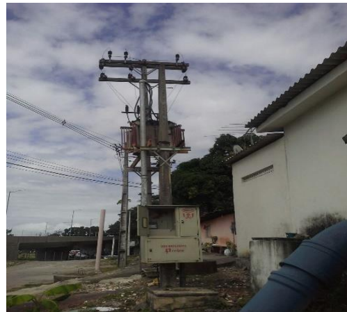
Figura 1: Subestação (SE) de 225 kVA. Fonte: os autores.
