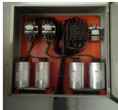
Figura 2: Banco capacitivo de 80 kvar. Fonte: os autores.
