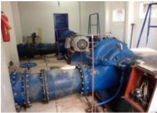
Figura 3: Conjuntos Motor-bomba. Fonte: os autores.
