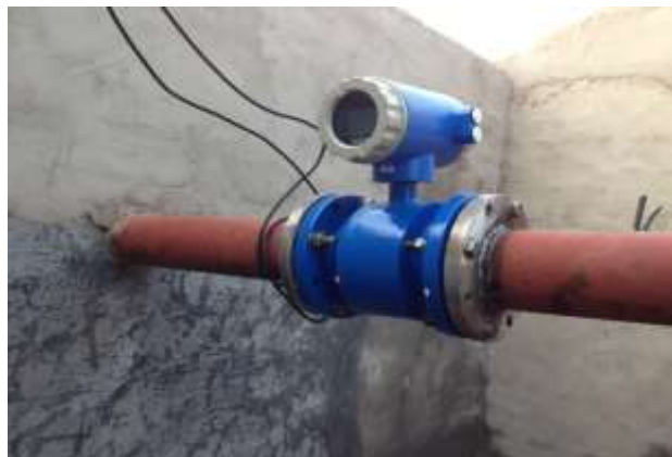
Figura 3: medidor de vazão eletromagnético versão compacta instalado – Fonte: https://sanesoluti.com.br/
