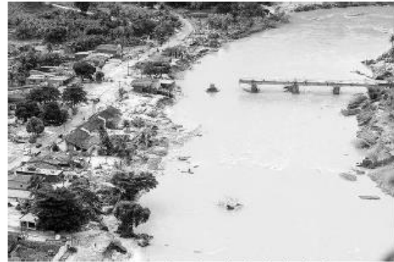
Fig. 05. Ponte levada pela cheia de junho/2010 no rio Una, em Barreiros Fonte: Secretaria Estadual de Imprensa
