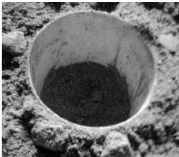
Fig 3. Caixa de inspeção do aterramento da betoneira.
