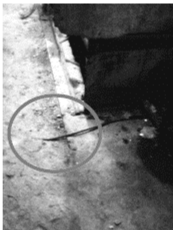
Fig 6. Aterramento da torre do elevador.
