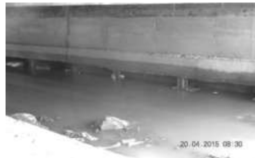
Figura 14 - Estacas metálicas expostas em área de variação de mares
