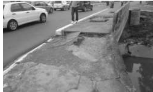
Figura 9 - Deformação do solo da passagem de pedestres.
