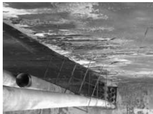
Figura 11 - Tubulações fixadas inadequadamente no tabuleiro da ponte.
