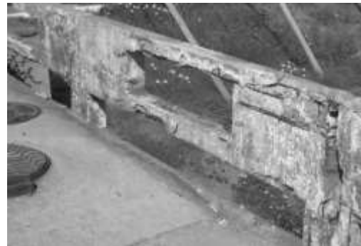
Figura10 - Guarda corpos danificados.
