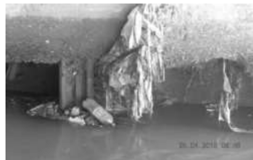
Figura 15 - Estacas metálicas com grande acúmulo de lixo.
