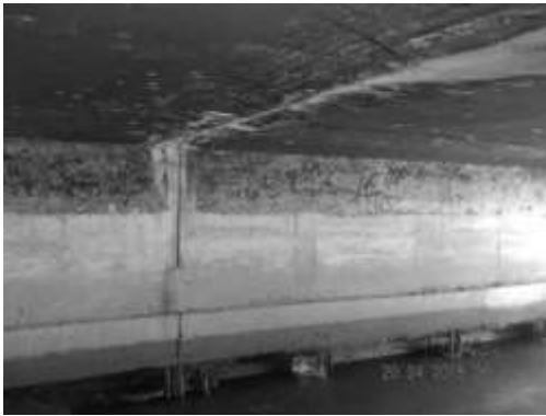
Figura 3 - Formação de bolor e mofo na laje do tabuleiro.
