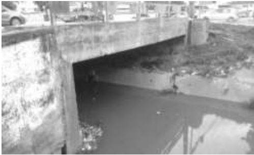
Figura 12 - Erosão no talude sob um dos lados da ponte.
