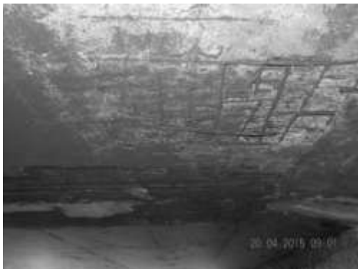
Figura 8 - Baixa espessura da camada de cobrimento da armadura, causando a exposição das mesmas.
