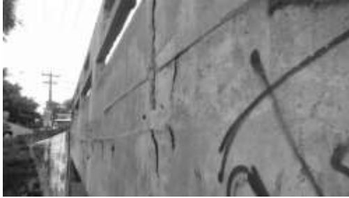
Figura 7 - Deslocamento do cobrimento do concreto que envolve a armadura lateral do tabuleiro.
