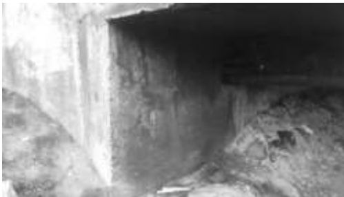
Figura 4 - Calcinação da estrutura causada por fogueiras sob a ponte.
