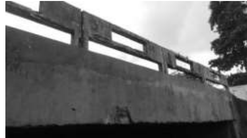
Figura 5 - Ausência de pingadeiras na borda da laje do tabuleiro da ponte.
