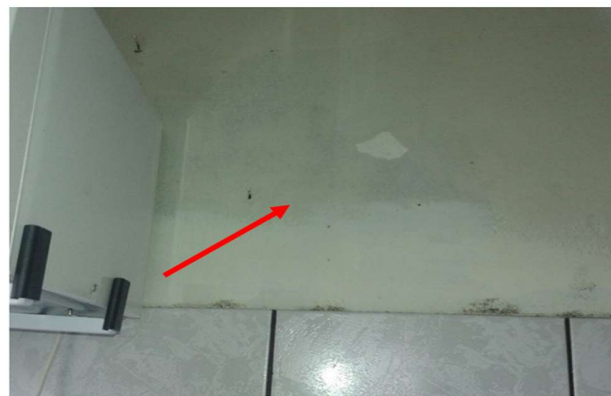
Figura 1: Presença de manchas de umidade na cozinha de uma residência do condomínio A
