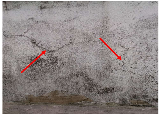
Figura 6: Presença de fissuras na fachada leste de uma edificação do condomínio B
