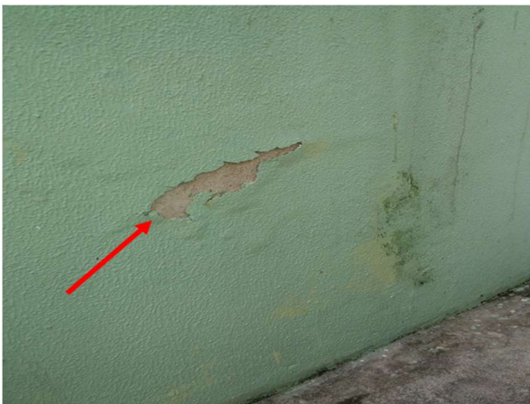
Figura 3: Destacamento da pintura da fachada norte de uma edificação do condomínio A
