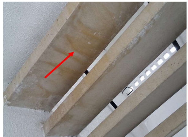
Figura 5: Presença de manchas castanhas abaixo das escadarias das edificações do condomínio B
