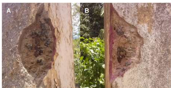
Figura 6: Ensaio de profundidade de carbonatação nos pilares P1 (A) e P2 (B)
