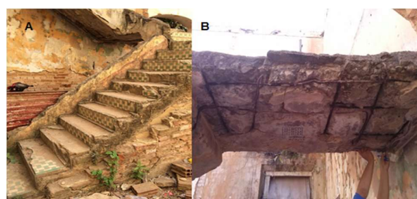
Figura 3: Revestimento danificado nos patamares da escada (A); Fundo da escada com falta de revestimento e exposição da armadura (B).
