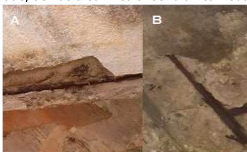
Figura 7: Ensaio de profundidade de carbonatação na escada (A) e marquise (B).
