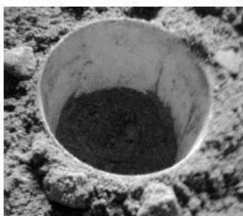
Fig 3. Caixa de inspeção do aterramento da betoneira.
