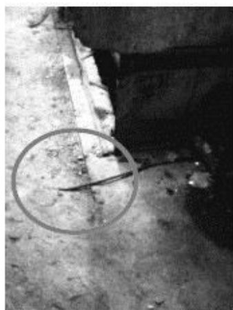
Fig 6. Aterramento da torre do elevador.
