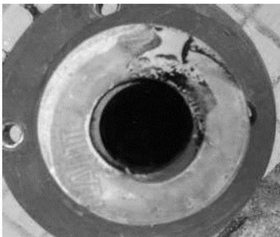
Figura 11. Alcatrão presente na tubulação.
